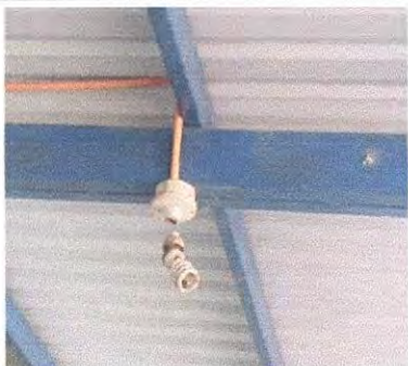
Foto 7: Se necesita reparación del sistema eléctrico.
