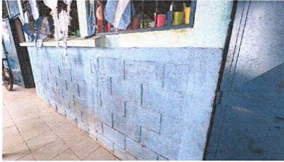
Foto 1: Se observa que se requiere aplicación de pintura en módulos.
