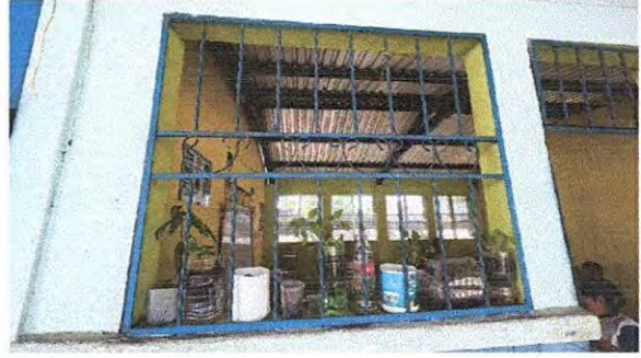
Foto 2: Se observa que los balcones necesitan mantenimiento.
