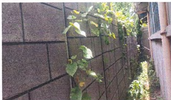
Foto 9: Se necesita aplicar pintura en muro perimetral.
