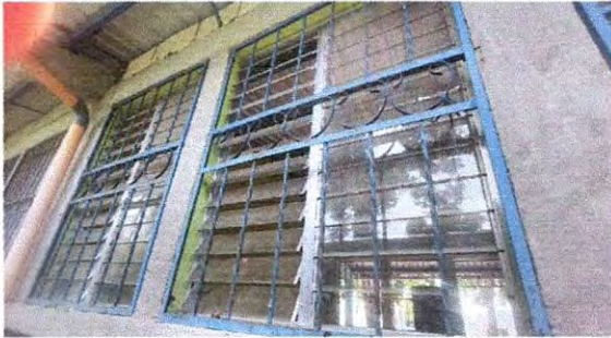
Foto 3: Se observa que se requiere sustitución de ventanas.
