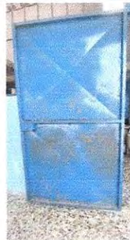
Foto 8: las puertas necesitan mantenimiento.
