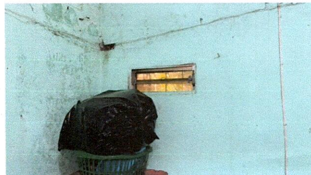
Foto 10: Se observa hay vanos no funcionales, por lo que se requiere cerrar.
