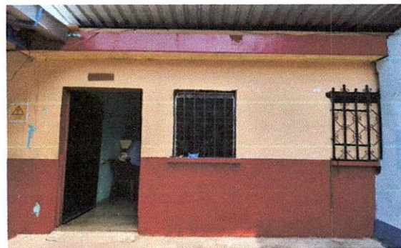
Foto 12: Se observa que se sustituirá la ventana.
