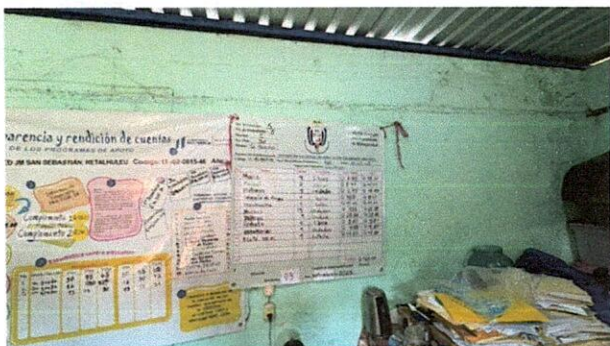
Foto 9: Se observa que la pintura está deteriorada.
