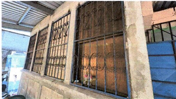
Foto 7: Se observa que los balcones requieren mantenimiento.
