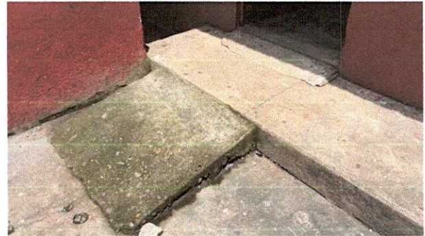
Foto 14: Se observa que no se cuenta con rampas en buen estado.
