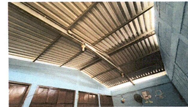
Foto 6: Se observa que los focos no tienen funcionamiento.
