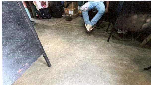
Foto 8: Se observa que no se cuenta con piso cerámico en dirección.
