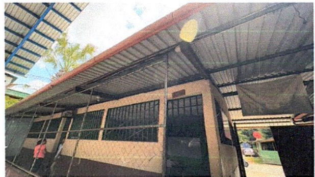
Foto 16: Se observa que la lámina se encuentra dañada.
