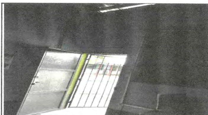
Foto 3: Se observa la necesidad de cambiar ventanas , quitar metal e instalar pvc.
