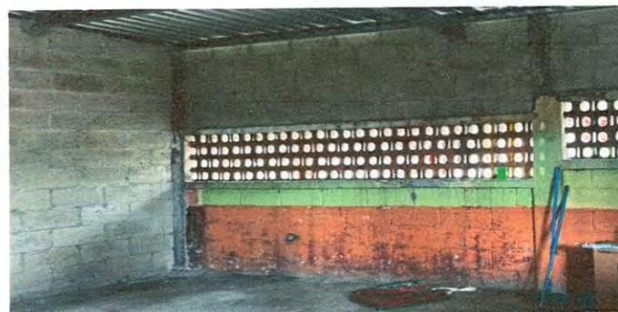
Foto 4: Se observa que las paredes no tienen cernido y hay que aplicarlo luego del repello.
