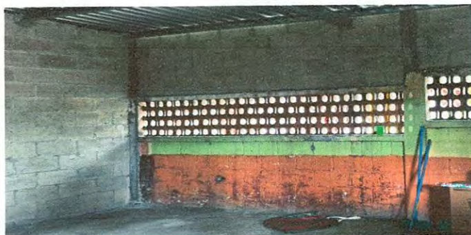
Foto 3: Se observa que las paredes no cuentan con repello.
