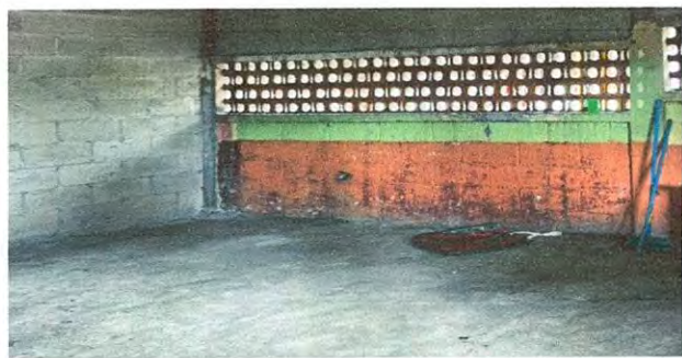
Foto 1: Se observa el piso de concreto, se necesita suministrar piso ceramico.
