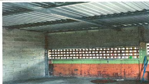
Foto 2: Se observa que las paredes no cuentan con pintura y algunas que si cuentan con ella ya estan muy manchadas
