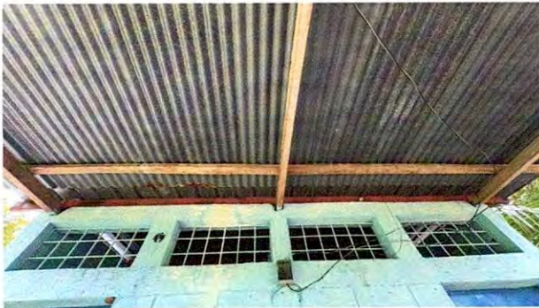
Foto 15: Se observa que la lámina se encuentra en mal estado.
