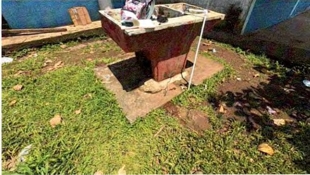
Foto 13: Se observa que no hay planchas de concreto completas por lo que los niños se ensucian al ir al baño.
