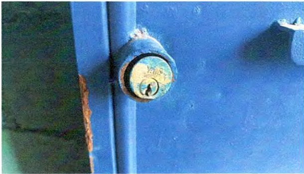
Foto 7: Se observa que las chapas ya no están en funcionamiento.
