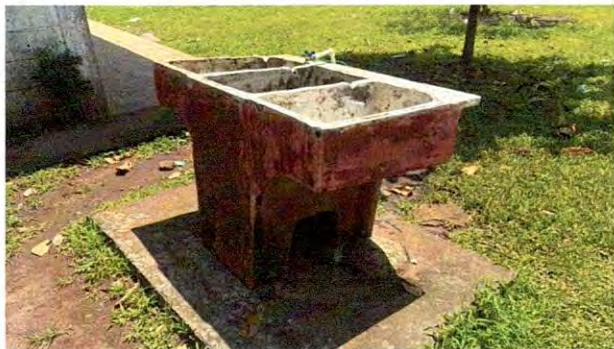
Foto 19: Se observa que la pila de cocina está en mal estado.
