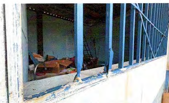
Foto 20: Se observa que los balcones de cocina se encuentran dañados.
