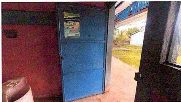
Foto 1: Se observa que las puertas se encuentran en mal estado por lo que requieren cambio.
