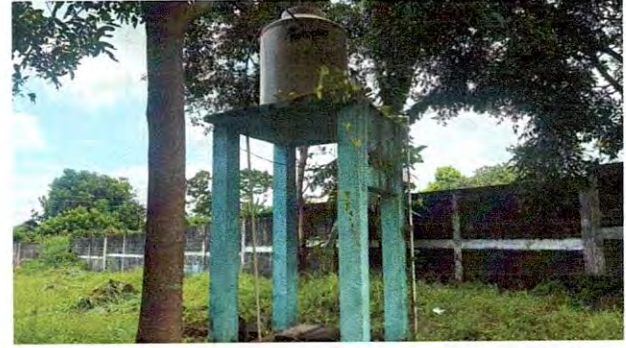
Foto 18: Se observa que la tubería de línea principal se encuentra dañada.
