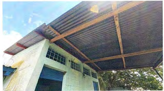
Foto 16: Se observa que la estructura de madera se encuentra en mal estado.
