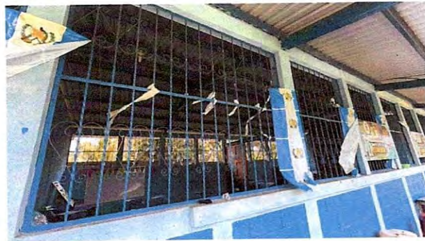
Foto 4: Se observa que los balcones requieren mantenimiento.
