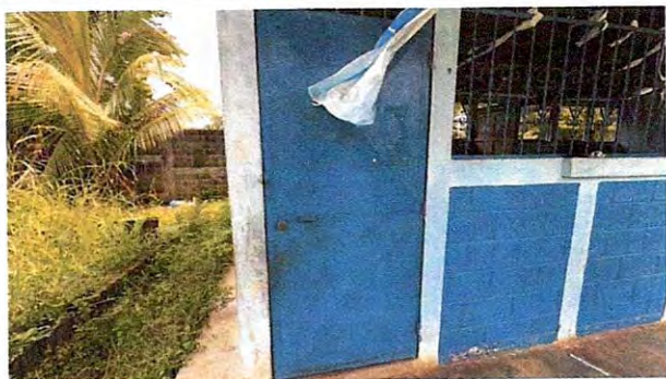
Foto 3: Se observa que las puertas requieren mantenimiento.
