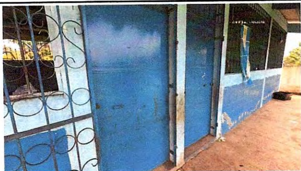
Foto 5: Se observa que no existe puerta de rejas y es necesaria.
