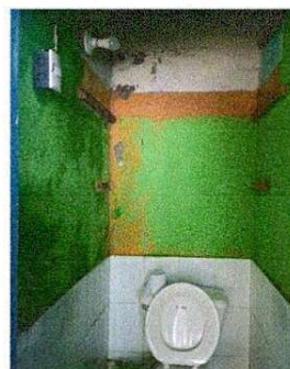
Foto 6: Se puede observar que las paredes de los baños mantienen mucha humedad, por lo que se requiere colocar azulejo para evitar el deterioro.
