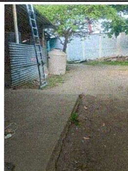
Foto 12: Se observa que el área que conecta el módulo de aulas hacia los baños es de tierra, en temporada de lluvia se pone lodoso y representa un riesgo para los alumnos, se requiere colocar un pasillo de concreto.
