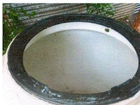
Foto 8: Se observa el depósito de agua, el cual requiere cambio en sus accesorios.
