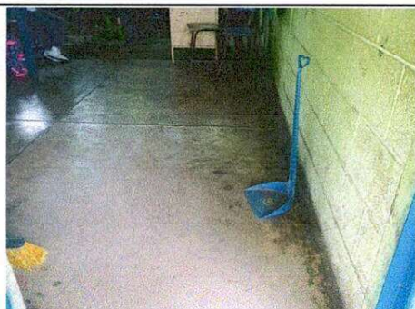
Foto 3: Se observa el piso de la primero básico, es de cemento el cual requiere que se coloque piso cerámico.
