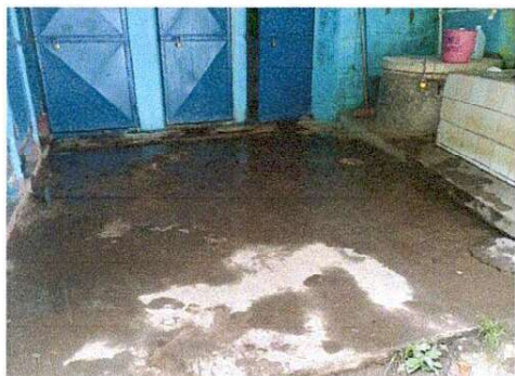
Foto 7: Se observa que el área de los baños al estar cerca de la pila y cuando llueve se reposa el agua y se pone resbaloso, lo que representa peligro para los jóvenes. Se requiere colocar piso antideslizante.
