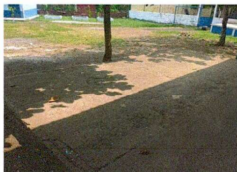
Foto 4: Se puede observar la plancha de concreto del escenario, el cual ya requiere mantenimiento.
