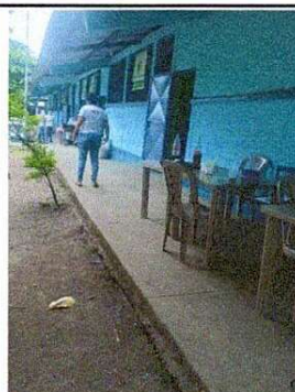
Foto 10: Se observa que los pasillos son de concreto, en temporada de lluvia se pone resbaloso, lo cual representa un riesgo para los alumnos. Se requiere instalación de piso antideslizante.
