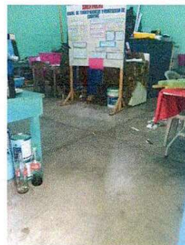
Foto 2: Se observa el piso de la dirección, es de cemento el cual requiere que se coloque piso cerámico.
