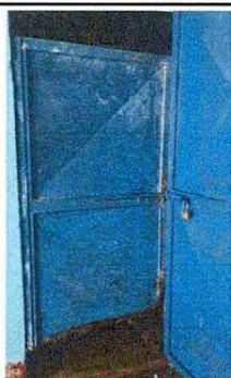
Foto 9: Se observa que las puertas de baño presentan deterioro, por lo que requieren mantenimiento.
