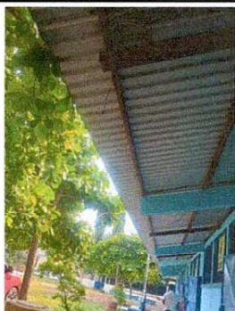
Foto 11: Se observa que el techo no tiene canal, al estar cerca del pasillo, el piso se pone resbaloso y el agua salpica en exceso en temporada de lluvia, se requiere colocar canal.
