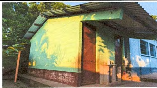
Foto 8: Se observa que la pintura de los servicios sanitarios se encuentra manchada y se esta cayendo.
