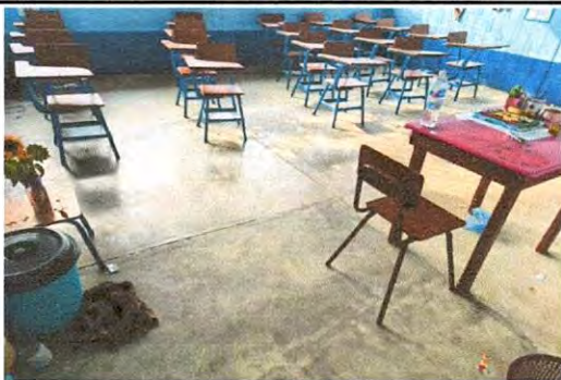
Foto 1: Se observa que no se cuenta con piso cerámico en el módulo de aulas 1, por lo que este deberá ser suministrado.
