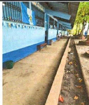
Foto 2: Se observa que el pasillo no cuenta con piso cerámico antideslizante, por lo que este deberá ser suministrado.
