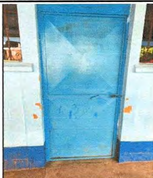
Foto 3: Se observa el inicio del deterioro y oxidación de las puertas del módulo 1 por lo que se brindará mantenimiento.
