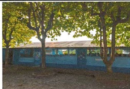
Foto 4: Se observa el deterioro de la lámina por lo que se deberá brindar mantenimiento, a su vez deberá realizarse el cambio de capote ya que este es muy corto y se encuentra dañado.
