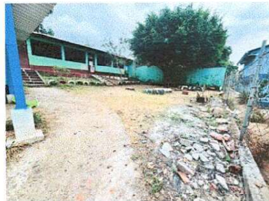
Foto 6: Se observa suelo deformado, es necesario suministrar torta de concreto.
