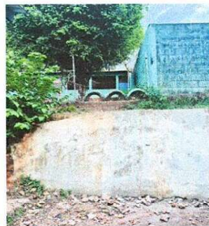
Foto 4: Se observa falta de accesibilidad al área, se debe realizar una banqueta con gradas.
