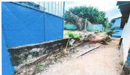
Foto 5: Se observa muro perimetral en mal estado, necesita ser reemplazado.
