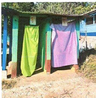
Foto 3: Se observa falta de puertas en el servicio sanitario de parvulos.
