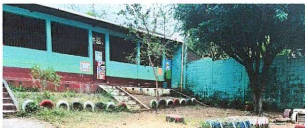
Foto 7: Se observa pintura en mal estado
