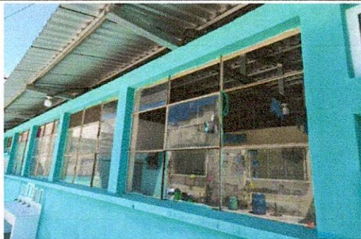
Foto 1: Se observa que se cuenta con ventanas de metal y vidrio, las cuales no brindan con ventilación debido a que no pueden ser abiertas y presentan piezas de vidrio faltantes.
