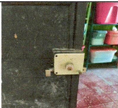
Foto 7: Se observa que la chapa del porton se encuentra dañada y no funciona bien por lo que deberá ser sustituida.
