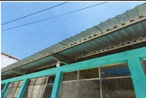
Foto 3: Se observa que existe un espacio entre el muro del módulo y la cubierta de lámina, por la que ingresan animales y lluvia; deberá sellarse con planchas de tablaroca para proteger el interior.
