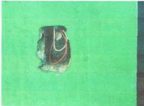
Foto 13: Se puede observar que en los baños no existe apagadores y no hay luz, debido a que se robaron el cable de energía, requiere mantenimiento.
