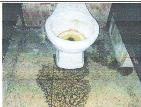
Foto 9: Se puede observar que el sistema de los baños está en mal estado.
