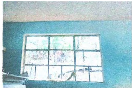
Foto 14: Se puede observar que la ventana del baño no es suficiente protección, ya ha habido casos que ladrones han ingresado por esa área, se requiere colocar ventana de metal para mayor seguridad y privacidad.
