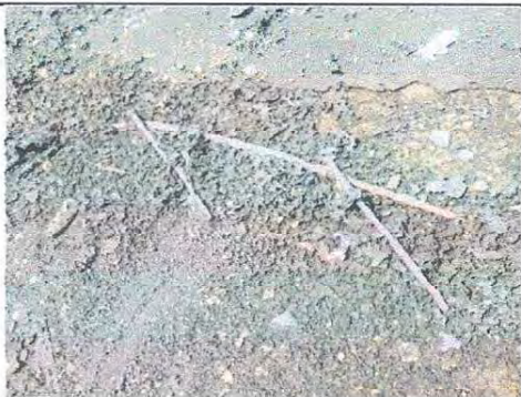
Foto 1: Se puede observar que la terraza esta deteriorada, lo que requiere reparación para evitar la humedad que se forma en el techo.
