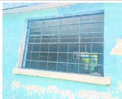
Foto 6: Se pueden observar la ventanas que se ubican en el aula, se han ingresado a robar, por lo que se requiere ventanas de metal para asegurar el lugar.
