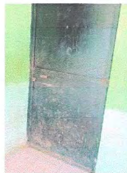
Foto 4: Se observa que las puertas presentan daño en las bisagras y en su estructura, por lo que requiere de mantenimiento.
