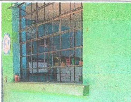
Foto 5: Se puede observar que las ventanas se han reforzado como balcón, requieren de mantenimiento para asegurar su vida útil.
