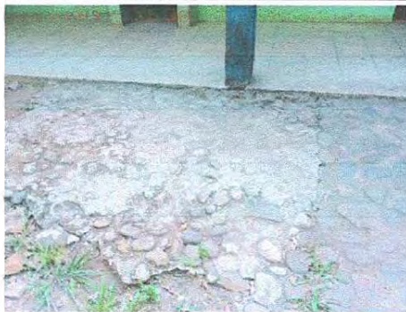
Foto 15: Se puede observar que el pavimento del patio ya esta bastante deteriorado, por lo que se requiere de reparación.
