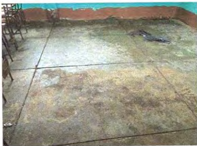
Foto 1: Se observan aulas sin piso cerámico
