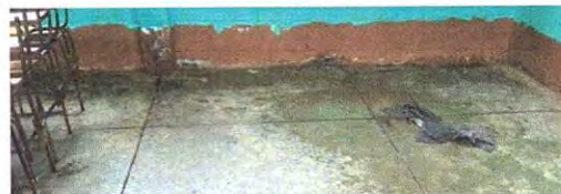
Foto 12: Se observan paredes manchadas y mal pintadas
