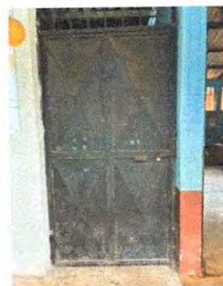
Foto 4: Se observan puertas con falta de mantenimiento
