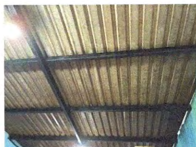
Foto 10: Se observa estructura de metal con presencia de corrosión
