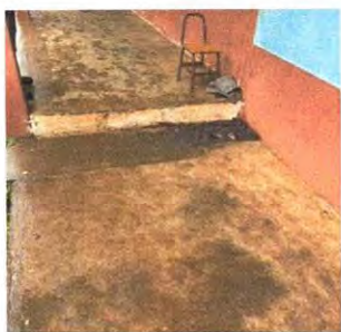
Foto 11: Se observan desniveles sin rampa en corredor
