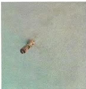
Foto 7: Se observa filtración de agua por la losa en un aula
