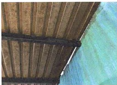
Foto 9: Se observa lámina con presencia de óxido y mal instalada
