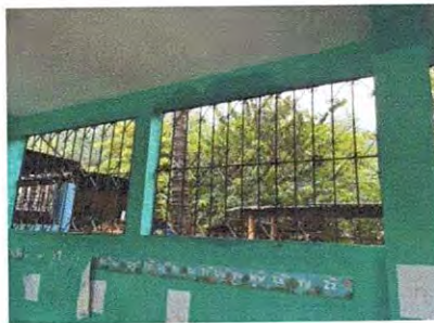
Foto 2: Se observan ventanales sin ventanas que permiten ingreso de lluvia
