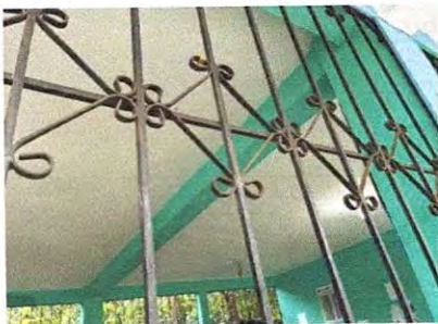
Foto 3: Se observan balcon con presencia de corrosión y falta de mantenimiento
