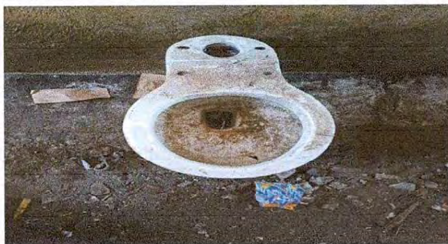
Foto 10: Se observa que los servicios sanitarios caducaron, por lo tanto, se instalarán servicios nuevos.
