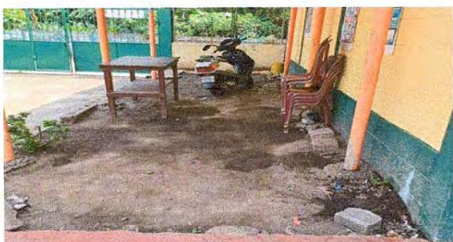
Foto 9: Se observa que en esta área no se cuenta con pavimento y los niños se caen, urge pavimentar.
