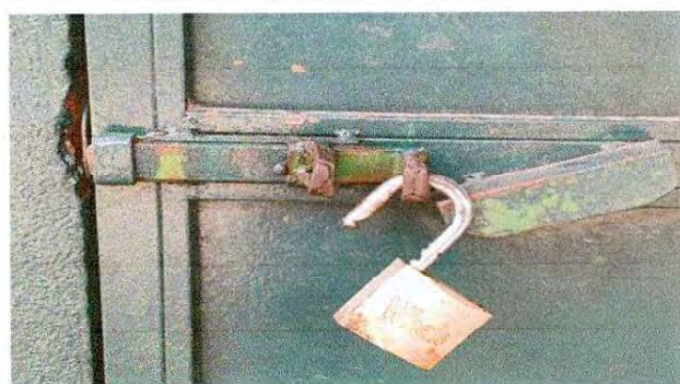
Foto 4: Se observa que las puertas no cuentan con chapa de seguridad. Se deben instalar.
