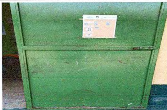
Foto 3: Se observa que las puertas de metal presentan picaduras en la parte inferior, se necesita darles mantenimiento
