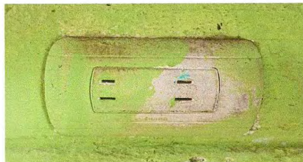
Foto 8: Se observa que los tomacorrientes y apagadores no funcionan debido al deterioro.
