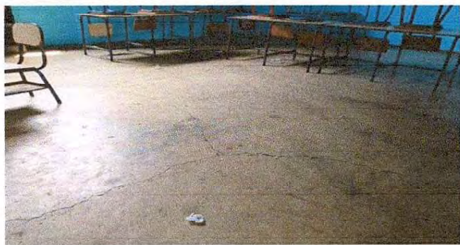
Foto 7: Se observa que los pisos alisados presentan desgastes y rajaduras, se instalará piso cerámico
