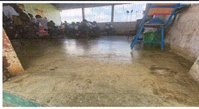
Foto 4: Se observan el piso con rajaduras y desgastes debido a las inundaciones en los salones de clases. Se pretende el suministro por piso cerámico
