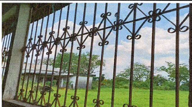
Foto 3: Se observa que no existe ventanas en el modulo de aulas 2 por lo que en invierno se suele filtrar el agua de lluvia.
