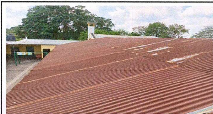
Foto 1: Se observa que el techado tiene láminas rajadas y muchas picaduras que provocan demasiada filtración de agua inundando las aulas
