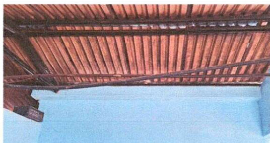
Foto 10: Se obser que las laminas de la cocina estan dañadas y deterioradas, deben ser sustituidas.
