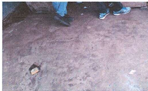
Foto 8: Se observa que frente a las pilas en el área de cocina, se necesita instalar piso cerámico antideslizante,
