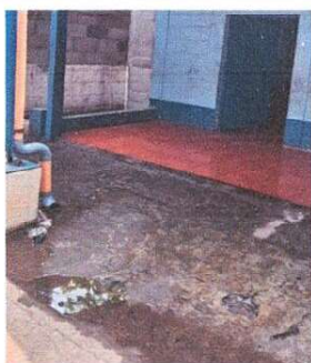
Foto 3: Se obseva que no se cuenta con una cuneta de concreto por lo que esta debe ser suministrada junto a su rejilla de metal.
