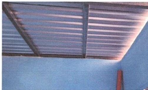
Foto 7: Se observa que en la dirección no se cuenta con sistema eléctrico.
