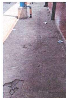
Foto 2: Se observa la el caminamiento frente a las aulas, debe ser reparado.
