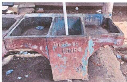
Foto 9: Se observa que la pila de cemento esta muy vieja y esta en mal estado, debe ser sustituida.
