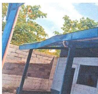
Foto 5: Se obseva que parte del canal de drenaje que se requiere sustituirlo.
