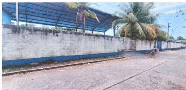
Foto 4: Se obseva que en el muro exterior la pintura esta manchada y deteriorada, necesita aplicación de pintura de primera calidad.
