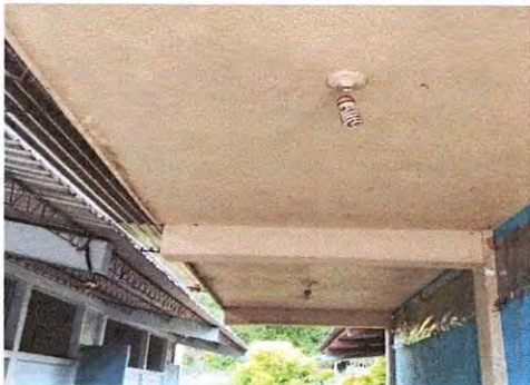
Foto 9: SE OBSERVA EL SISTEMA ELÉCTRICO EN MAL ESTADO.
