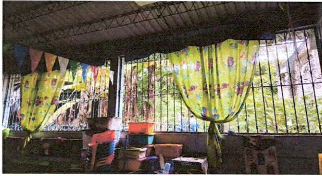
Foto 1: SE OBSERVA QUE HACE FALTA VENTANAS DE PVC.
