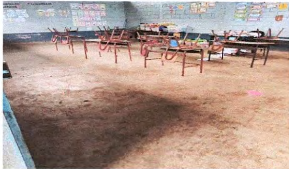
Foto 3: SE OBSERVA PISO DE CEMENTO, SE NECESITA COLOCAR PISO CERÁMICO.
