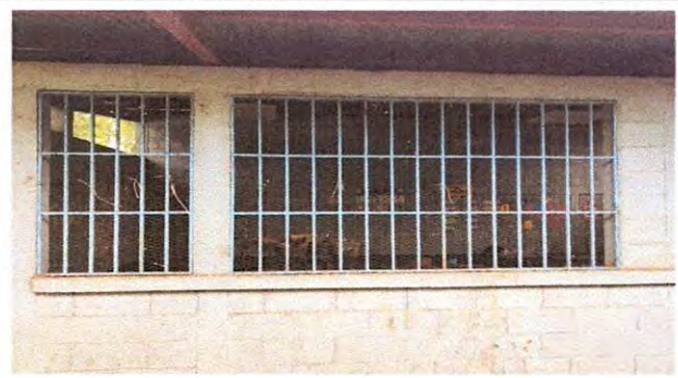
Foto 2: SE OBSERVA BALCONES SIN PINTURA Y CON ÓXIDO, SE NECESITA DARLE MANTENIMIENTO.
