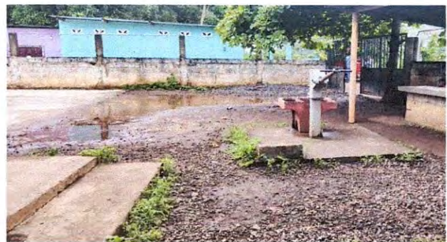
Foto 10: SE OBSERVA LA FALTA DE PLANCHA DE CONCRETO EN EL PATIO.
