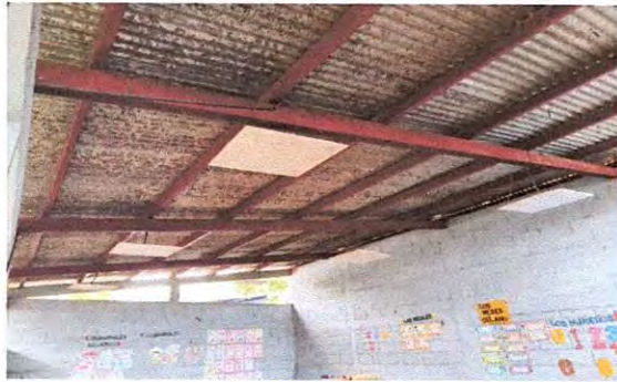
Foto 7: SE OBSERVA LA ESTRUCTURA DE SOPORTE DE METAL ÓXIDA Y FALTA DE PINTURA, SE NECESITA DARLE MANTENIMIENTO.
