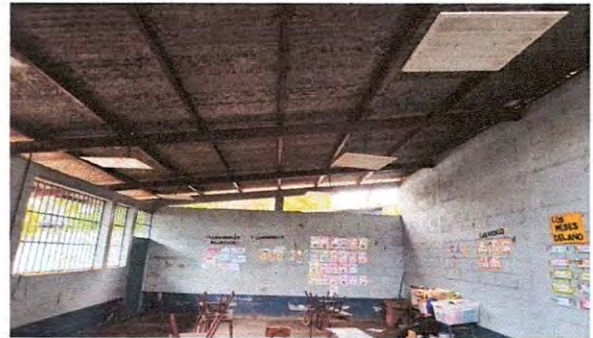
Foto 8: SE OBSERVA LA LÁMINA DETERIORADA Y MAL ESTADO, SE NECESITA SE CAMBIE.
