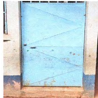
Foto 4: SE OBSERVA PUERTA SIN PINTURA Y CON ÓXIDO, SE NECESITA DARLE MANTENIMIENTO.
