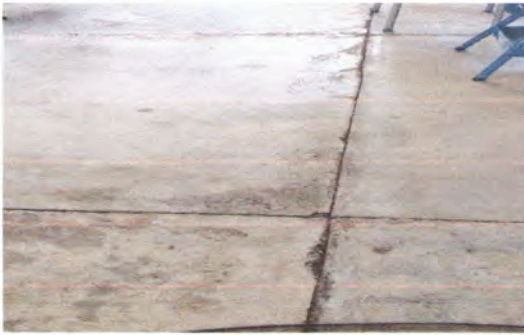
Foto 1: Se observa el mal estado del piso de los salones de clase.
