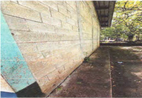
Foto 3: Se observa lo sucio de la escuela y la ausencia de pintura.
