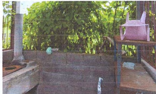
Foto 8: se Observa que los muros de cocina no cuentan con pintura.
