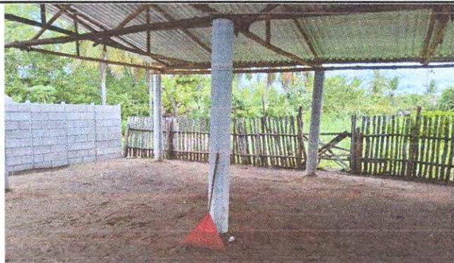
Foto 1: Se observan deterioro físico de balla perimetral se necesita muro perimetral
