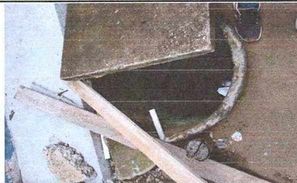
Foto 2: se Observa que el pozo no cuenta con bomba
