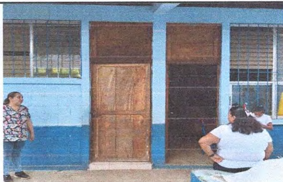
Foto 11: Se observa la puerta en mal estado.
