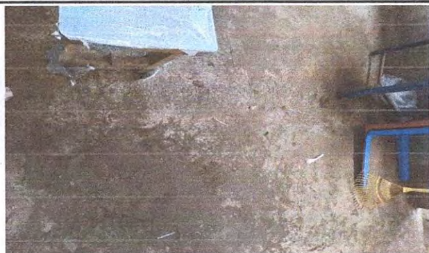
Foto 9: Se observa el deterior físico del piso de concreto.
