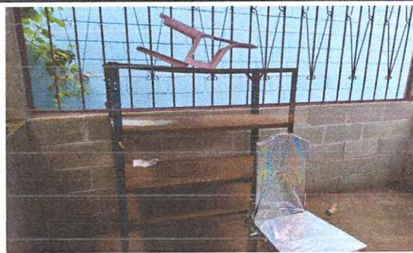
Foto 10: Se observa el muro de cocina interior que necesita azulejo.
