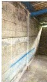
foto 2: se observa la necesidad de repellar el muro en modulo de bodega
