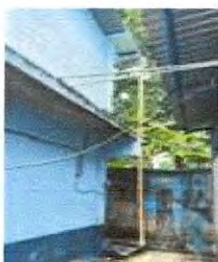
Foto 23: se observa la necesidad de instalar tubería línea principal
