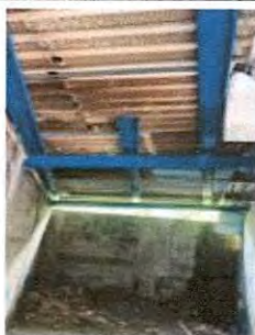
Foto 3: se observa la necesidad de suministrar sistema electrico en modulo de bodega
