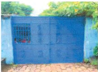
Foto 27: se observa la necesidad de dar mantenimiento a porton de metal.
