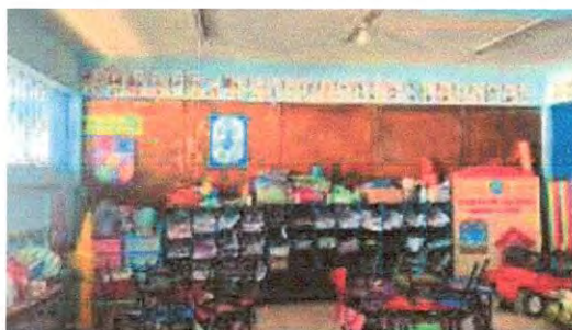
Foto 14: se observa la necesidad de sustituir el entrepaño de playwood en aula del modulo 2.
