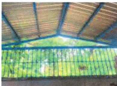
Foto 9: se observa la necesidad de instalar barandas de metal en cocina escolar
