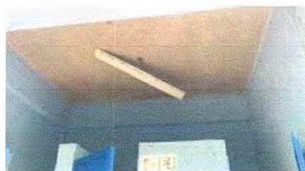
Foto 20: se observa la necesidad de instalar sistema electrico en modulo de baños
