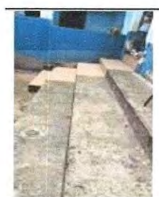
Foto 24: se observa la necesidad de instalar piso ceramico antideslizante
