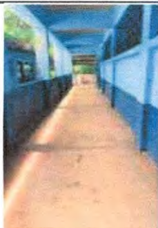
Foto 15: se observa la necesidad de instalar piso ceramico antideslizante en el modulo 2
