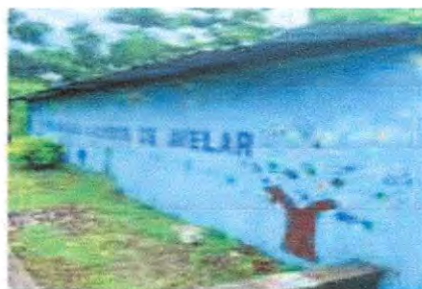
Foto 26: se observa la necesidad de aplicación de pintura latex en muro perimetral frontal
