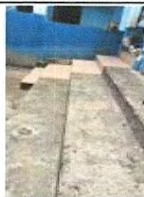
Foto 22: se observa la necesidad de instalar piso ceramico antideslizante en modulo de baños
