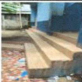
Foto 21: se observa la necesidad de sustituir banqueta de concreto en modulo de baños
