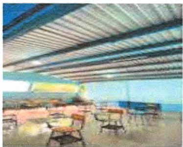
Foto 25: se observa la necesidad de instalar sistema electrico
