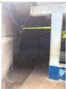
Foto 1: se observa la necesidad de suministrar puerta en modulo de bodega
