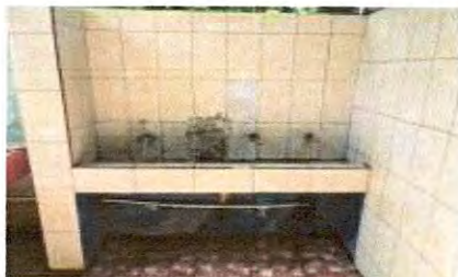
Foto 19: se observa la necesidad de sustituir el azulejo en modulo de baños
