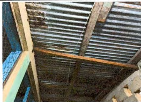
Foto 16: Se observa que la estructura de soporte de madera presenta signos de putrefacción por lo que deberá ser sustituida.
