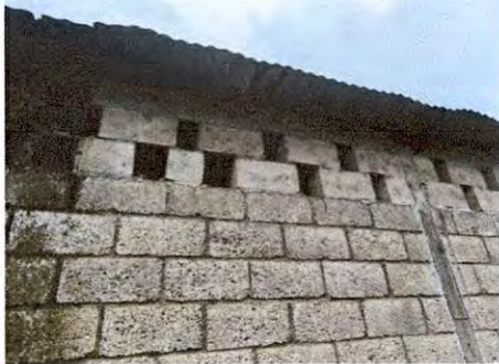
Foto 13: Se observa que el muro perimetral cuenta con una disposición de block inadecuada y sectores con daños en las columnas por lo que deberá de ser reparado.
