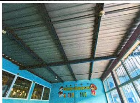
Foto 8: Se observa que el laboratorio de computación del módulo 2, no cuenta con cielo falso, deberá suministrarse para evitar el calor y el daño en equipos.
