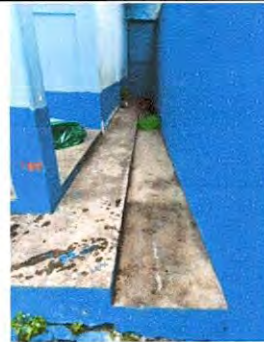
Foto 14: Se observa que el caminamiento se encuentra desnivelado y no cuenta con gradas para facilitar su acceso.
