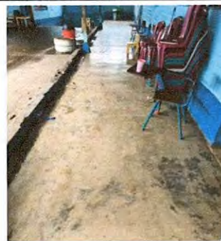
Foto 2: Se observa que el pasillo del módulo 1 no cuenta con piso cerámico, este deberá ser antideslizante.
