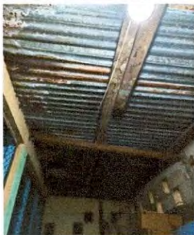
Foto 15: Se observa el deterioro y oxidación de la lámina por lo que deberá ser sustituida.
