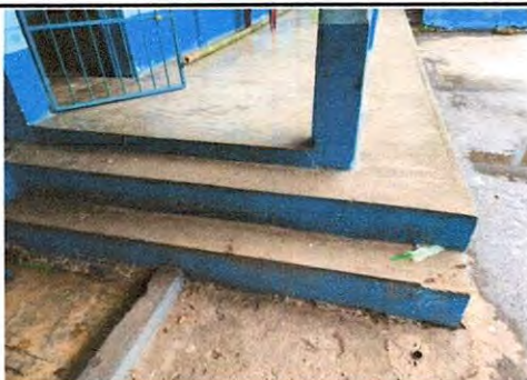
Foto 9: Se observa que las gradas de acceso al módulo de aulas 2 son muy altas por lo que deberán ser reparadas.
