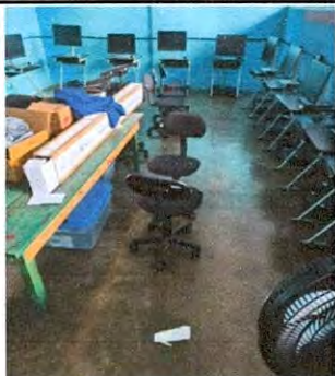
Foto 7: Se observa que no se cuenta con piso cerámico en el laboratorio de computación del módulo de aulas 2.
