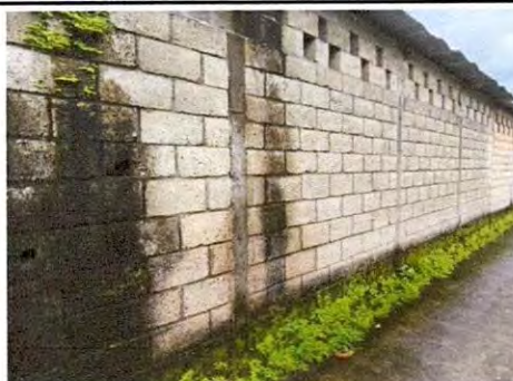
Foto 10: Se observa humedad en el muro por lo que debe ser protegida mediante la aplicación de repello.
