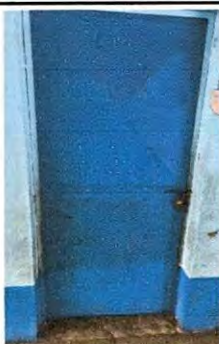
Foto 3: Se observa el inicio del deterioro y daño en las puertas por lo que deberán recibir mantenimiento.
