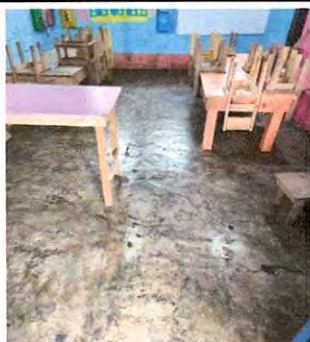
Foto 1: Se observa que las aulas en el módulo 1 no cuentan con piso cerámico y el piso de concreto se encuentra deteriorado.
