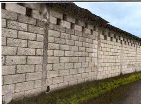
Foto 11: Se observa que el muro no cuenta con pintura por lo que luego de ser repellido deberá ser pintada.
