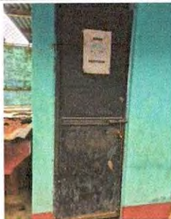
Foto 3: Se observan puertas de servicio sanitario en mal estado
