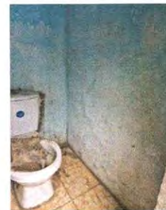
Foto 6: Se observa falta de azulejo en baños
