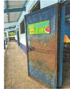
Foto 2: Se observan puertas dañadas y en mal estado
