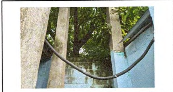
Foto 10: Se observa inseguridad por falta de reja en pared perimetral
