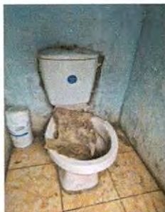
Foto 5: Se observan inodoros en muy mal estado
