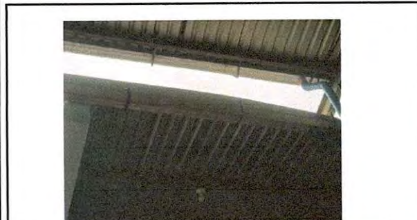
Foto 9: Se observa canal con agujeros
