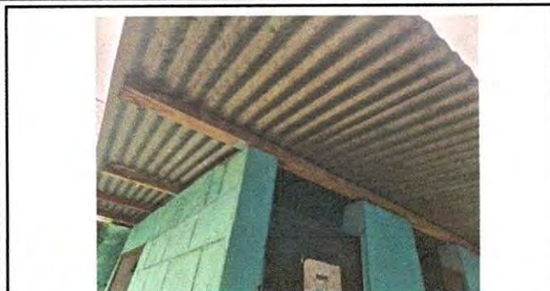
Foto 7: Se observa estructura de metal en mal estado
