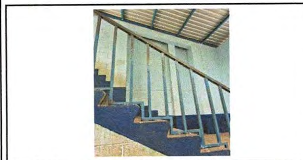
Foto 11: Se observa baranda con falta de mantenimiento
