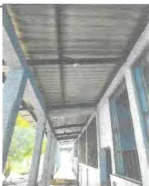
Foto 9: Se observa la necesidad reparación de las iluminaria dañadas
