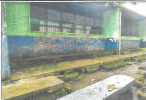
Foto 1: Se observa la necesidad de pintar el exterior
