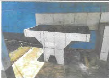
Foto 7: se observa que la pila del establecimiento se encuentra deteriorada
