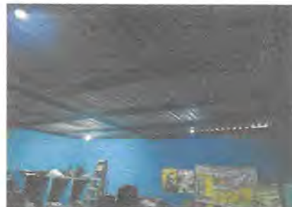
Foto 14: Se observa Falta de mantemineto de la electromaya
