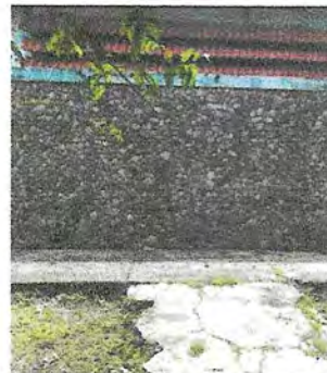
Foto 2: Se observa Falta de mantenimiento al muro de piedra del establecimiento
