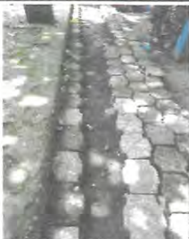
Foto 5: se observa la necesidad de tener un encaminamiento por en el tiempo de lluvia en esa lugar se hace demasiado lodo
