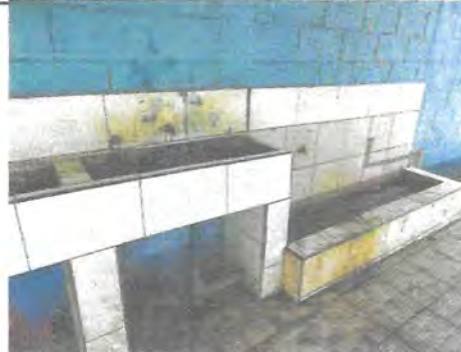
Foto 8: Se observa la necesidad un nuevo lavado de concreto
