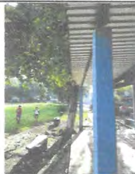
Foto 10: La observa la necesidad de un canal de metal
