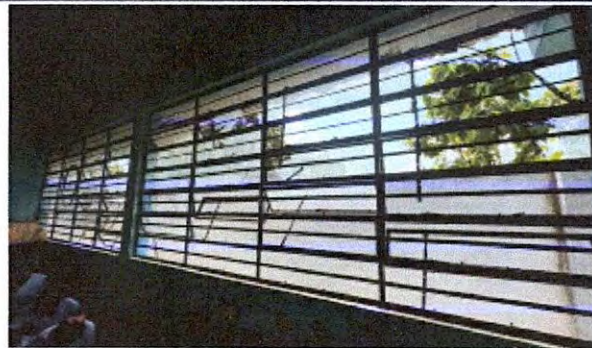
Foto 2: Se observa que las ventanas antiguas se encuentran dañadas.
