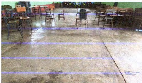
Foto 1: Se observa que no se cuenta con piso cerámico.
