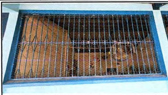
Foto 8: Los balcones requieren mantenimiento
