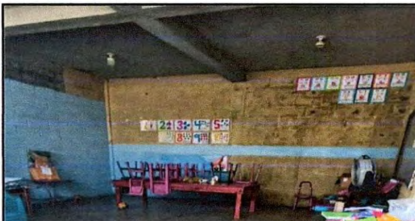
Foto 5: Se necesita pintar los salones de clase
