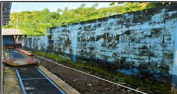
Foto 1: Muro deteriorado es necesario repararlo
