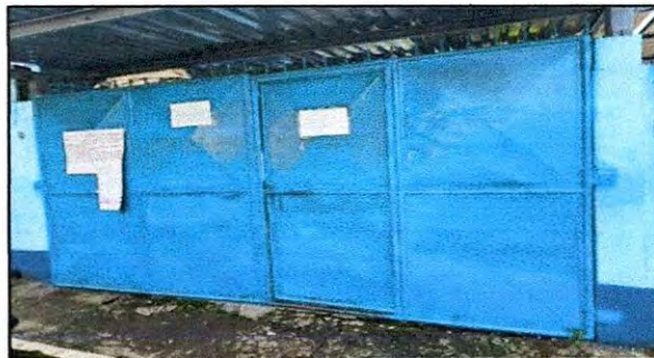
Foto 6: El portón requiere mantenimiento
