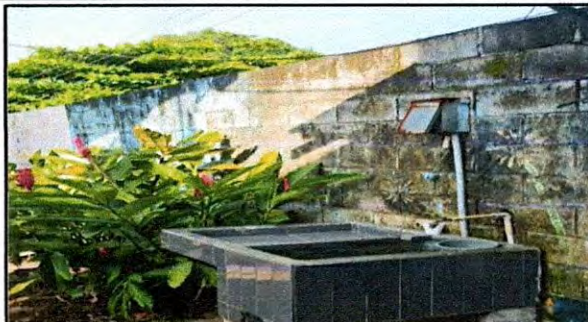
Foto 2: Muro perimetral debe ser repellido para su mejoramiento
