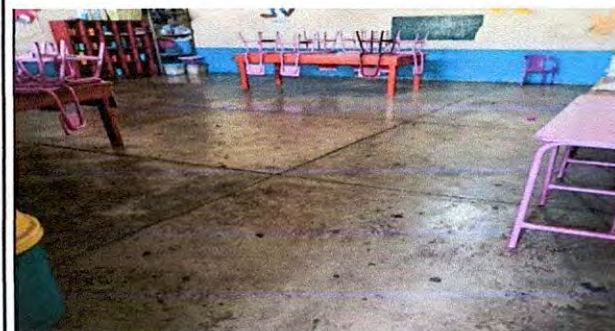
Foto 9: Colocar dañado debe ser sustituido por uno antideslizante
