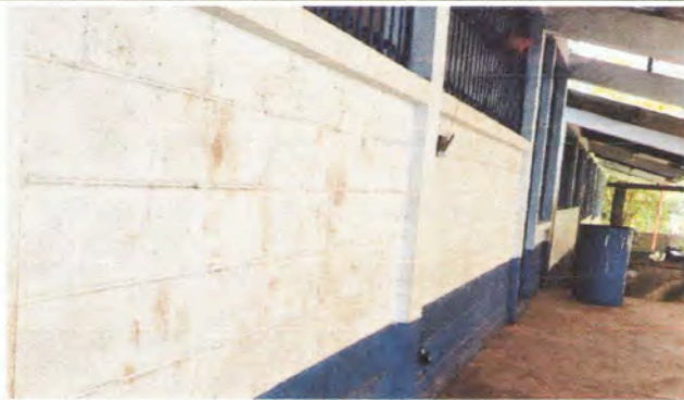
Foto 3: Se observa lo sucias y deterioradas que se encuentran las paredes de la escuela.
