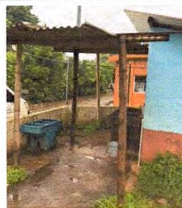
Foto 6: Se observa área de lavado de manos en baño con lámina en mal estado
