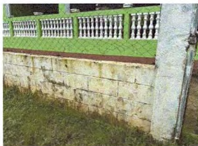
Foto 1: Se observa cerca perimetral con agujeros y sin refuerzos
