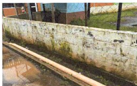
Foto 2: Se observa muro perimetral sin repello y afectado con humedad
