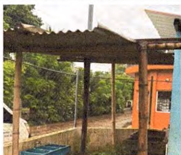
Foto 7: Se observa soporte de lámina de madera
