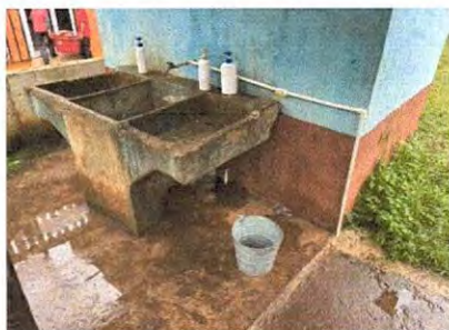
Foto 9: Se observa la no existencia de área de lavado de manos, actualmente compartida con pila para lavado de trapeadores
