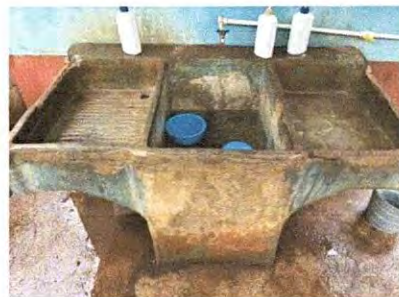
Foto 8: Se observa pila con daños visibles y exposición de alma
