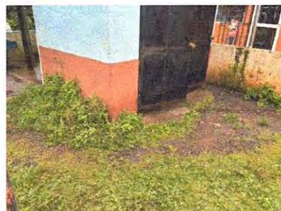
FOTO 14: Se observa falta de caminamiento para acceso a baños
