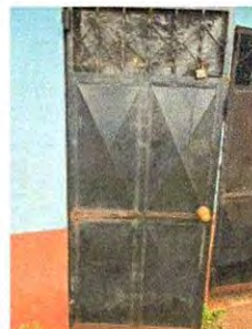
Foto 10: Se observan puertas de sanitarios con falta de mantenimiento
