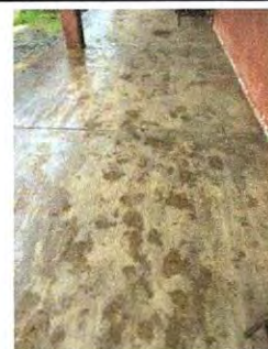
Foto 4: Se observa pasillo exterior sin piso antideslizante
