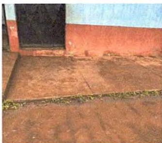
Foto 3: Se observa cambio de nivel en caminamiento y con poca elevación del suelo de tierra
