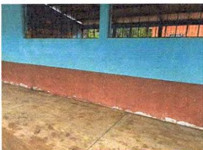
Foto 5: Se observan paredes sucias y con falta de mantenimiento
