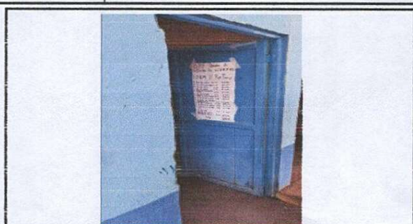
Foto 2: Se observa la necesidad suministrar una puerta de metal
