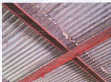
Foto 9: Se nota el deterioro de la cubierta de lámina
