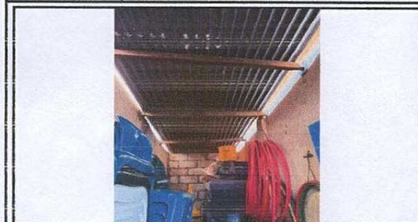
Foto 1: Se observa el mal estado de la estructura y cubierta de la bodega
