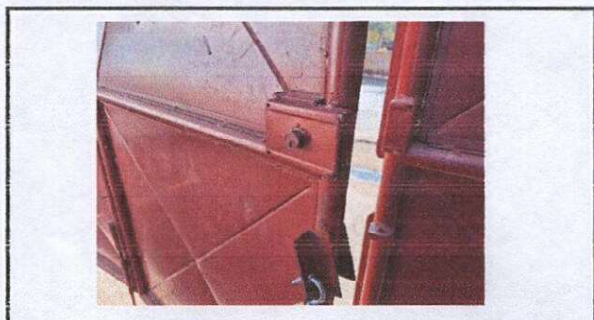
Foto 4: Es necesario suministrar una chapa de primera calidad para el porton de entrada principal
