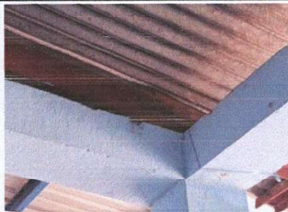
Foto 8: se observa la necesidad de sustituir la estructura de madera por metal
