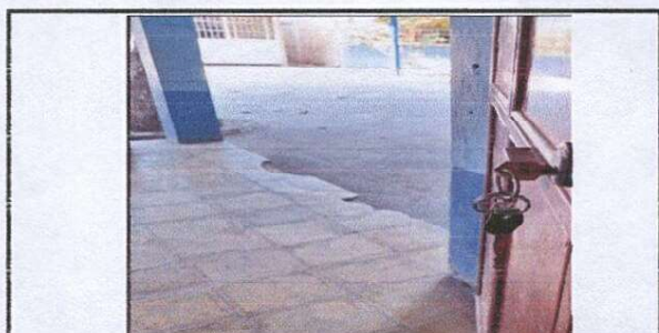
Foto 6: Es necesario suministrar u sustituir el piso ceramico
