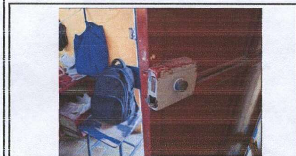
Foto 3: Se observa el mal estado de la chapa de una puerta de aula
