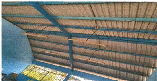
Foto 7: Se observa que las unidades del sistema eléctrico ya no funcionan por lo que deben ser sustituidas.
