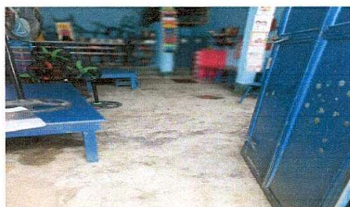
Foto 3: Se observa el piso de las aulas es de concreto, siendo necesario suministrar piso cerámico.
