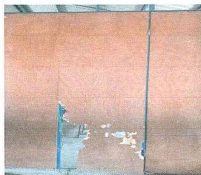
Foto 4: Se observa en mal estado divisiones de playwod en el salón de usos múltiples se sustituirá por metal.
