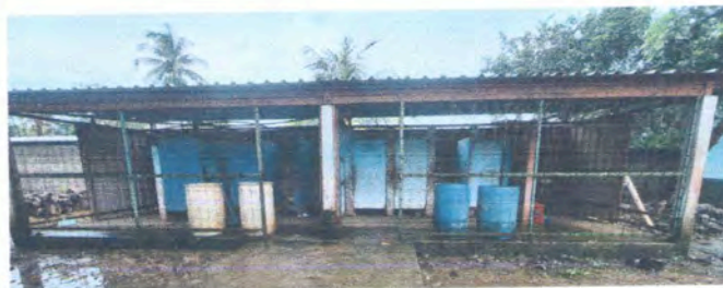
Foto 2: los baños necesitan piso antideslizante (cerámico)
