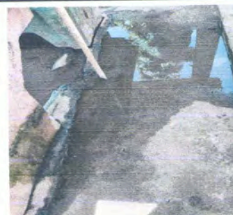
Foto 6: pilas necesitan cambio de tubería de drenaje, y colocación de caja de registro.
