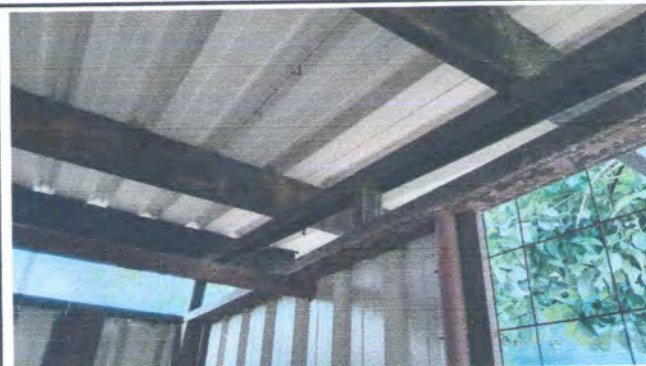
Foto 4: la estructura de techos y paredes del servicio sanitario necesitan mantenimiento
