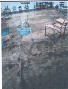
Foto 1: el piso de las aulas necesita piso cerámico
