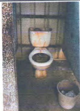
Foto 3: los inodoros de los servicios sanitarios necesitan cambio
