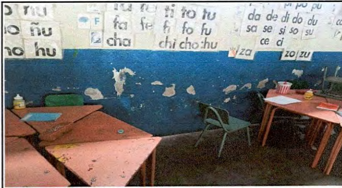
Foto 8: se observa la necesidad de aplicar repello.
