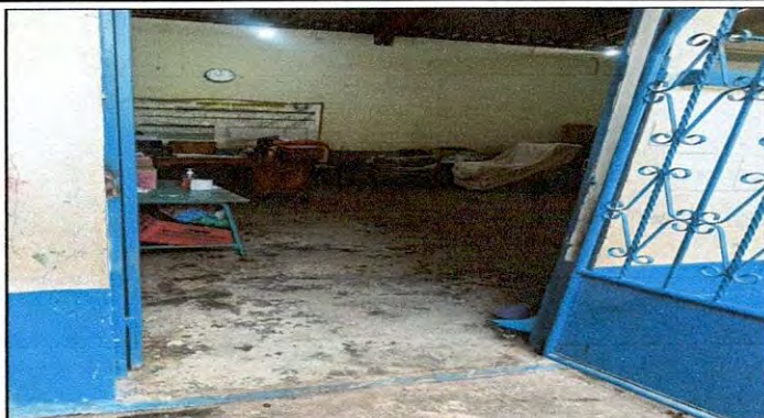
Foto 1: Se observa el piso en mal estado, es necesario instalar piso cerámico.
