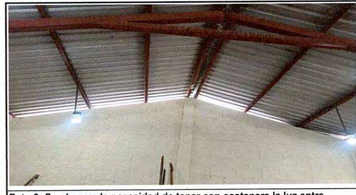
Foto 6: Se observa la necesidad de tapar con costanera la luz entre mojinete y el techo.
