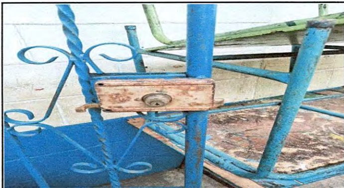
Foto 7: Se observa la chapa en mal estado y necesita sustitución.
