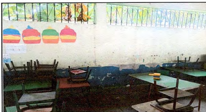
Foto 9: Se observa la necesidad de aplicar impermeabilizante.
