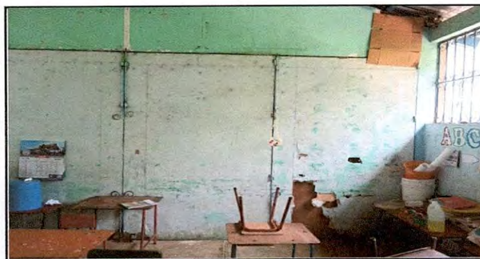
Foto 11: Se observa la necesidad de cambiar los cancelles.
