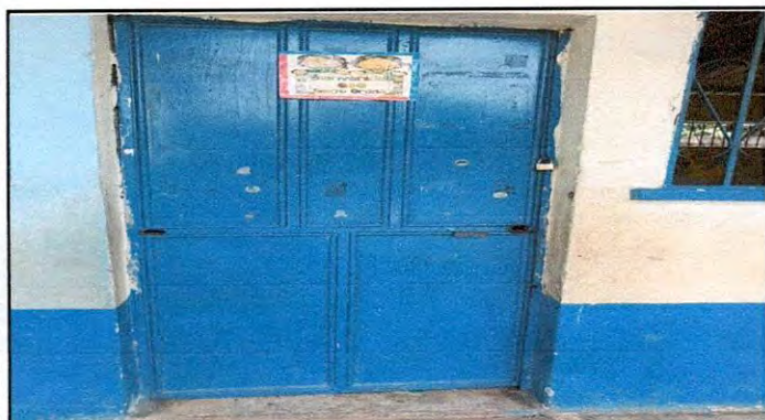
Foto 3: Se observa que la puerta necesita sustitución.
