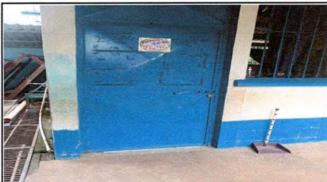
Foto 15: Se observa la necesidad de mantenimiento de puertas.
