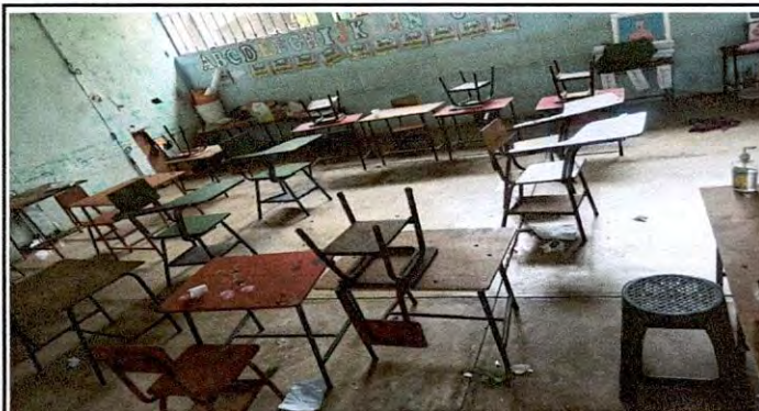
Foto 13: Se observa la necesidad de instalación de piso ceramico.
