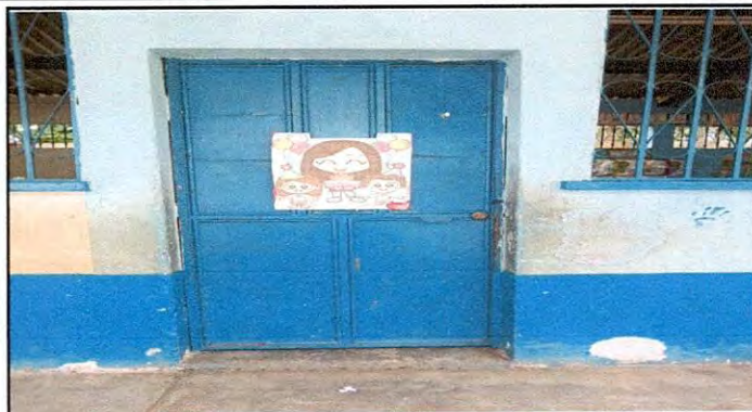
Foto 2: se observa que las puertas de metal necesitan mantenimiento.
