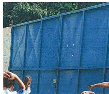
Foto 10: Se observa el portón de la entrada de la escuela, el cual no cierra bien, se necesita cambiarle la chapa.
