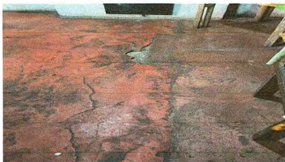
Foto 3: Se observa que el piso de la cocina está en mal estado por lo que se le instalara piso cerámico.
