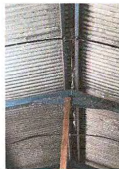
Foto 8: Se observa que la lámina tiene agujeros y por el capote se filtra el agua de la lluvia. Es necesaria su sustitución.
