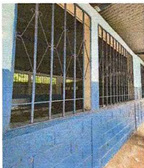
Foto 15: Se observa que los balcones ya están oxidandose y despintándose, por lo que se necesita el mantenimiento de todos los balcones de la escuela.
