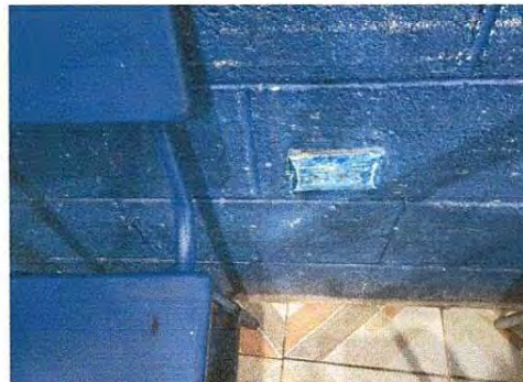
Foto 16: Se observa que el tomacorriente no está en buen estado, y no tiene corriente eléctrica, por lo que se necesita su sustitución.
