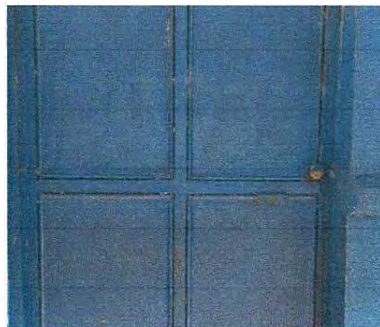
Foto 14: Se observa que la chapa ya está deteriorada.
