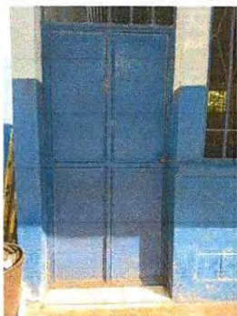
Foto 13: Se observa que las puertas de metal estan con desperfectos y se dificulta cerrarlas, requieren mantenimiento.
