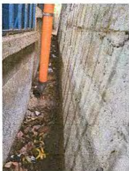
Foto 7: Se observa la pared que tiene filtración de agua en excesiva cantidad en el modulo de aulas 2.
