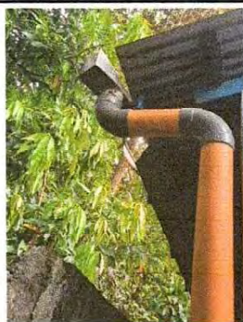
Foto 9: Se observa que en el canal de metal se cuela el agua de lluvia, pues posee un gran agujero.
