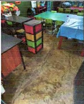
Foto 7: Se observa que dentro del aula del módulo 1 no se cuenta con piso cerámico, por lo que este deberá ser suministrado.
