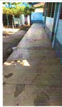
Foto 8: Se observa que en el corredor frente al módulo 1 no se cuenta con piso cerámico antideslizante, por lo que deberá ser suministrado.
