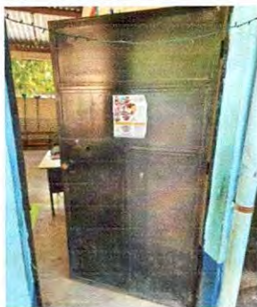
Foto 5: Se observa el deterioro y oxidación de las puertas del módulo 1, por lo que deberán recibir mantenimiento.
