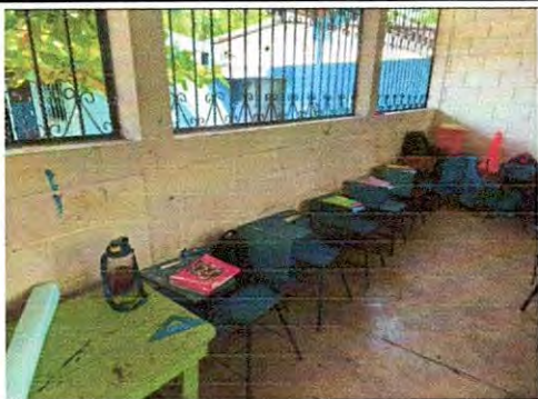
Foto 9: Se observan manchas y deterioro en la pintura de las aulas del módulo 1 por lo que se deberá aplicar nueva pintura.
