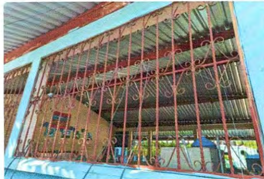
Foto 4: Se observa el inicio del deterioro de los balcones por lo que estos deberán recibir mantenimiento.
