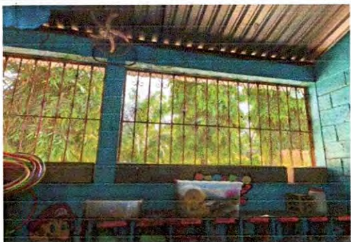
Foto 3: Se observa que en la parte posterior del módulo, al igual que en el frente de la dirección, no se cuenta con ventanas de PVC y vidrio por lo que ingresa agua de lluvia.
