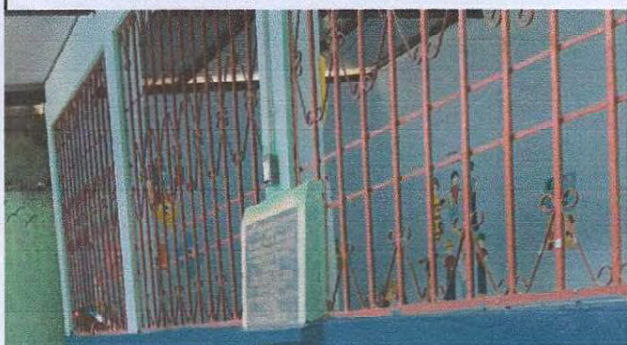
Foto 5: Se evidencia que se necesita sustitución de balcones de metal.
