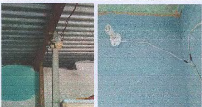
Foto 9: Se observa que urge la sustitución del sistema eléctrico en tres aulas.
