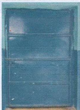
Foto 1: Se observa que urge la sustitución de puerta en una de las aulas.
