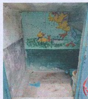
Foto 4: Se observa que urge suministro e instalación de indoro y puertas exteriores en servicios sanitarios.
