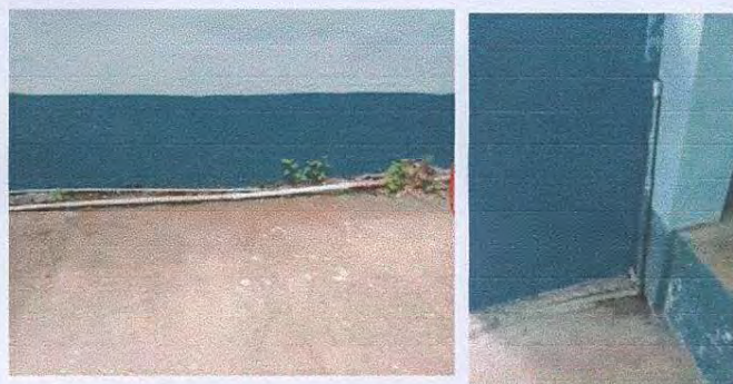
Foto 7: Se aprecia la necesidad de sustituir la tubería lineal principal.
