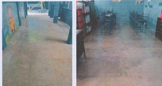
Foto 2: Se evidencia que el piso de dos aulas está en mal estado. Se requiere urgentemente su sustitución.
