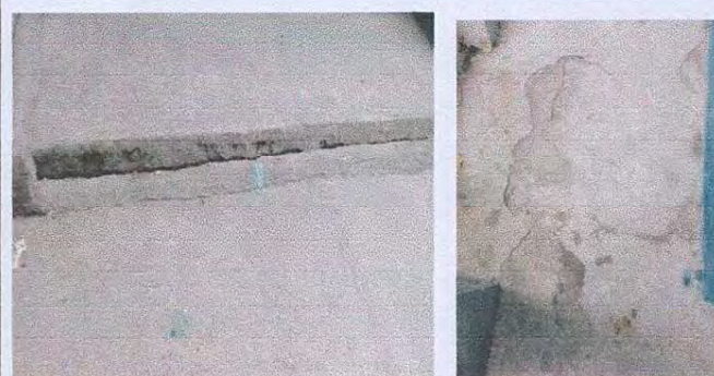
Foto 8: Se observa que urge la reparación de planchas de concreto hidráulico en el patio.
