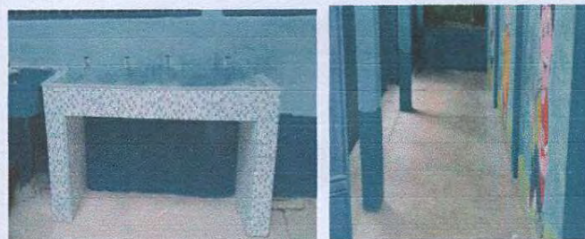
Foto 6: Se observa que se necesita suministro e instalación de azulejo.
