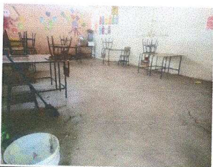
Foto 1: Se observa que el piso es de concreto, se necesita suministrar piso cerámico.
