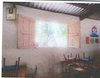
Foto 4: Se observa que las ventanas son de madera, necesita ser sustituida por metal.
