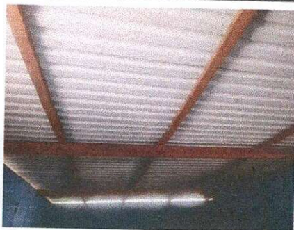
Foto 3: Se observa que la estructura es de madera, y se sustituirá por estructura de metal.
