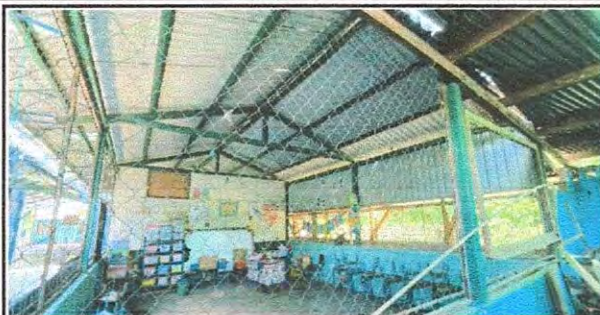
Foto 1: Se observa que la lamina existente tiene deterioro por lo que es urgente que se sustituya.
