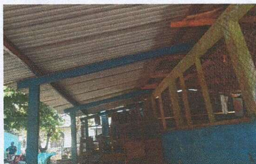
Foto 2: Se observan costanera que solo necesitan mantenimiento
