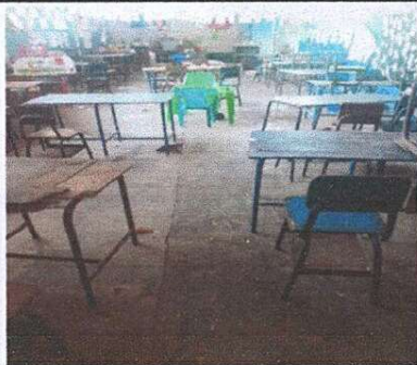
Foto 7: Se observa piso en mal estado, interior aula, se instalara piso cerámico
