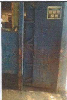
Foto 5: Se observan puertas en pésimas condiciones
