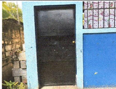
Foto 4: Es necesario sustituir las puertas, ya se encuentran en mal estado.
