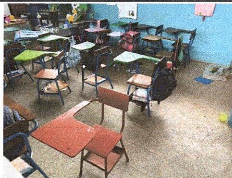
Foto 2: Por el tiempo es necesario sustituir el piso cerámico dentro de las aulas.
