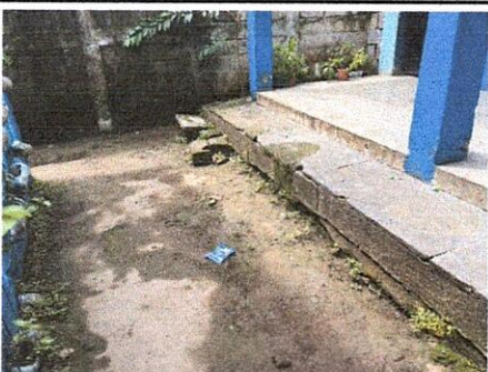
Foto 5: Es de vital importancia suministrar una pila y sus conexiones de agua potable y drenaje, cerca del área de primer nivel.
