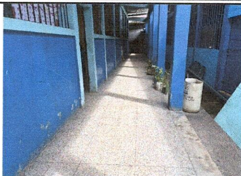
Foto 7: Es necesario mejorar el aspecto del módulo, por lo que es necesario pintarlo.
