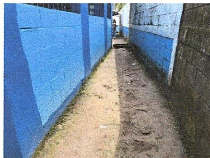
Foto 6: En temporada de lluvia se hace mucho lodo, es necesario suministrar una plancha de concreto.
