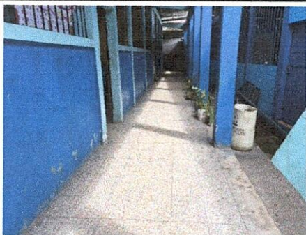
Foto 1: Es necesario sustituir el piso, ya ha cumplido su función al pasar los años.
