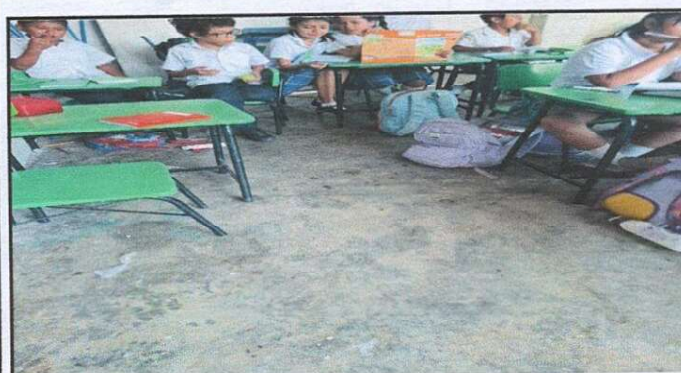
Foto 3: Se observa el piso en mal estado, urge sustituirlos módulo I y II
