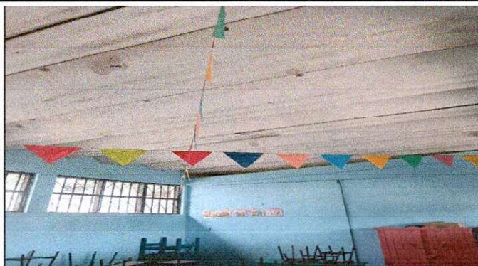
Foto 2: Se observa la falta de estructura de metal
