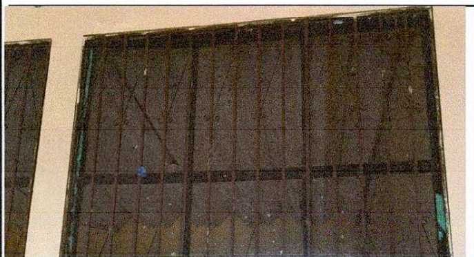
Foto 3: Se observa que los balcones necesitan mantenimiento con pintura anticorrosiva
