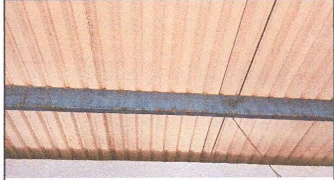
Foto 2: SE OBSERVA LA ESTRUCTURA DE SOPORTE DE METAL ÓXIDADA Y SIN PINTURA, SE NECESITA DARLE MANTENIMIENTO.
