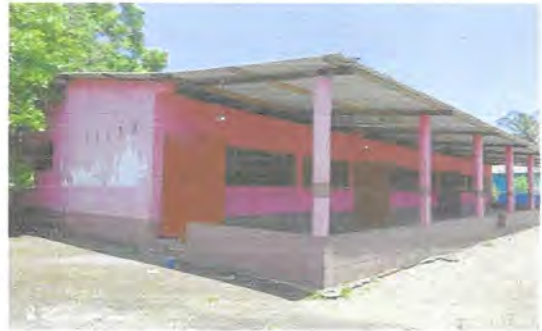
Foto 2: Se observa la necesidad de mejorar Pintura de cada una de las puertas
