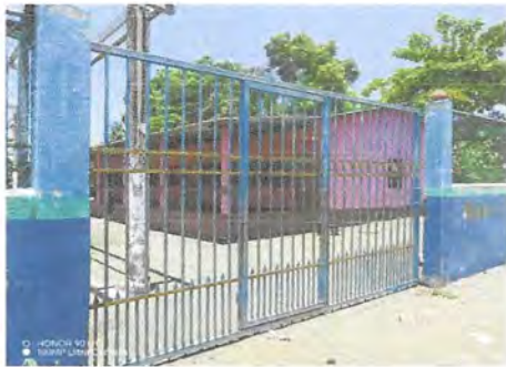
Foto 3: se observa que el porton necesita pintura ya que ha y partes con óxido
