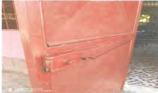
Foto 1: Se observa la necesidad de Cambiar la chapa de la puerta
