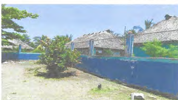
Foto 10: no se cuenta con torre de cemento para la instalación de suministro de agua por lo cual es necesario la instalación de una
