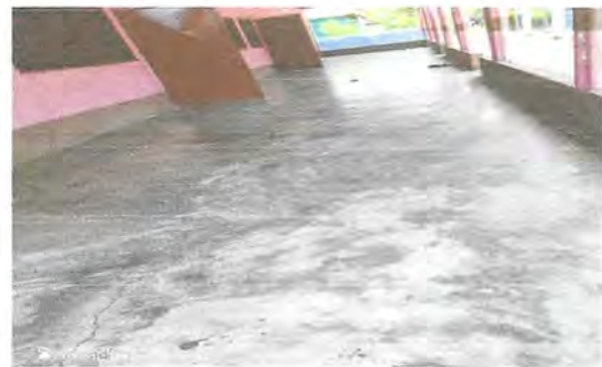
Foto 4: el piso se encuentra bastante deteriorado por la cual se tiene la necesidad de mejorar la calidad
