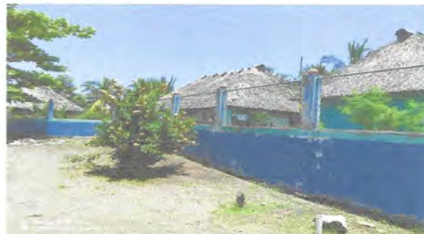
Foto 8: se observa que no hay existencia de deposito de agua para uso de baños
