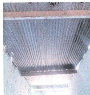
Foto 4: Se observa el mal estado del soporte de estructura de lamina por lo que se necesita cambio del mismo
