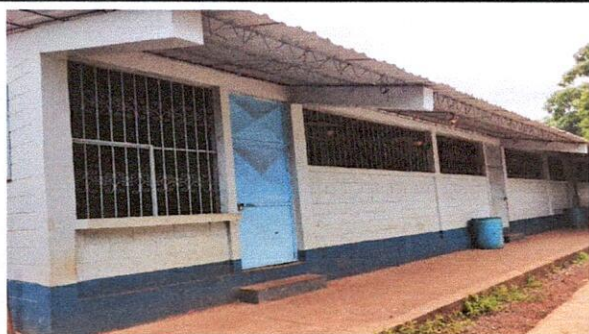
Foto 5: SE OBSERVA LA PARED SUCIA, ES NECESARIO SE BRINDE MEJORAS DE PINTURA.
