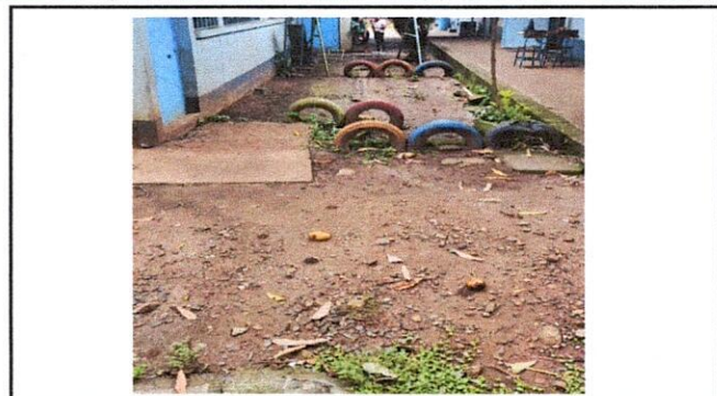
Foto 8: SE OBSERVA LA FALTA DE PLANCHA DE CONCRETO EN EL PATIO.
