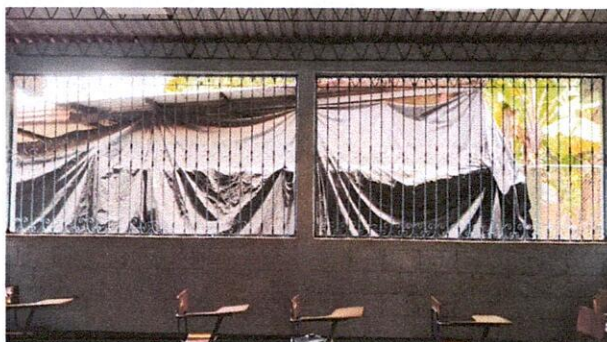
Foto 1: SE OBSERVA QUE HACE FALTA VENTANAS DE PVC.
