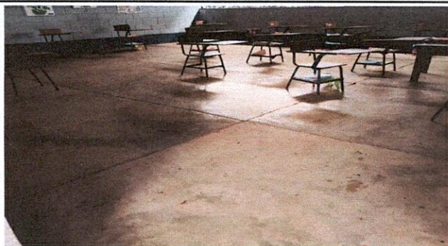
Foto 3: SE OBSERVA PISO DE CEMENTO, SE NECESITA COLOCAR PISO CERÁMICO.
