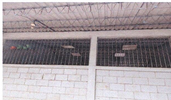
Foto 2: SE OBSERVA BALCONES SIN PINTURA Y CON ÓXIDO, SE NECESITA DARLE MANTENIMIENTO.
