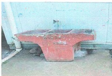
Foto 21: Se observa que la torata de concreto cuenta con undimientos por motivo que es muy delgada y esta agrietada
