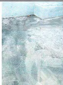
Foto 1: Se observa que no se cuenta con piso antideslizante
