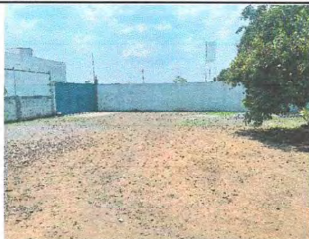
Foto 7: Se observa que la pila no cuenta con salida de agua negras, en la imagen se observa donde pasara la tuberia de pvc para la parte frontal de la escuela.
