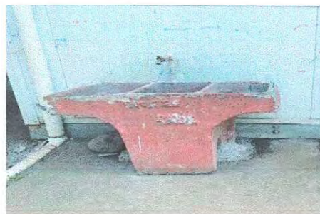
Foto 20: Se observa que la pila se encuentra en mal estado
