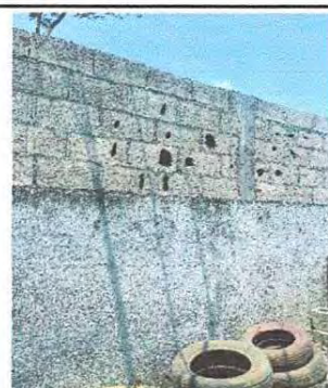
Foto 16: Se observa que la pared se encuentra en mal estado, por motivo que los ladrones han dañado la estructura del muro.
