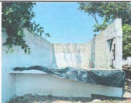
Foto 15: Se observa que la cocina no cuenta con pintura se debe pintar para proteger los muros y generar buena estetica.
