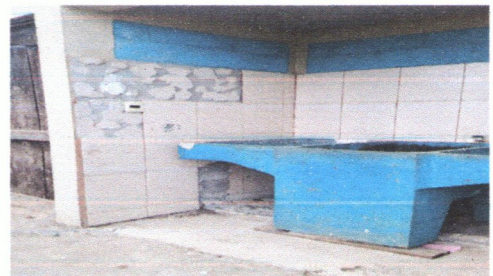
Foto 6: se observa el azulejo caído.
