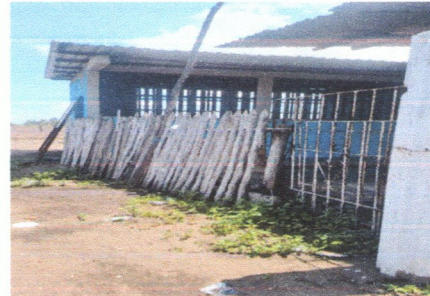
Foto 4: se observa la necesidad de cambiar la cerca perimetral
