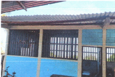
Foto 3: Se observa la necesidad de colocar canales.
