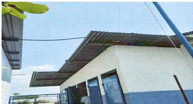
Foto 1: Se observa que la lámina, se encuentra en mal estado.
