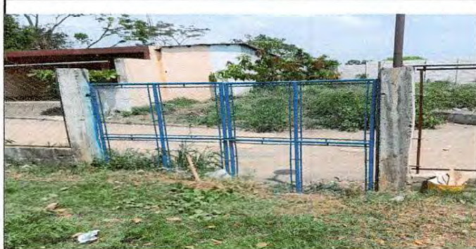
Foto 9: Se observa que el porton no es funcional por lo que debe ser reemplazado.
