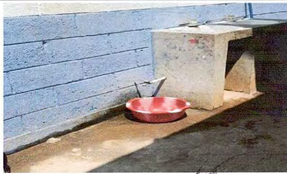
Foto 6: Se observa que el area de lavado es insuficiente, de suministrar otra estacion de lavado.
