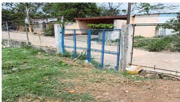
Foto 7: Se observa la necesidad de reparación de muro perimetral, se eliminara el porton y se debe cerrar ese espacio con muro bajo y malla galvanizada.
