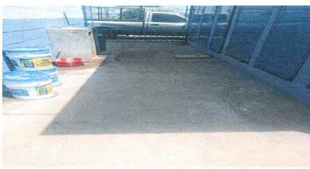
Foto 4: Se observa la necesidad de piso ceramico antideslizante.
