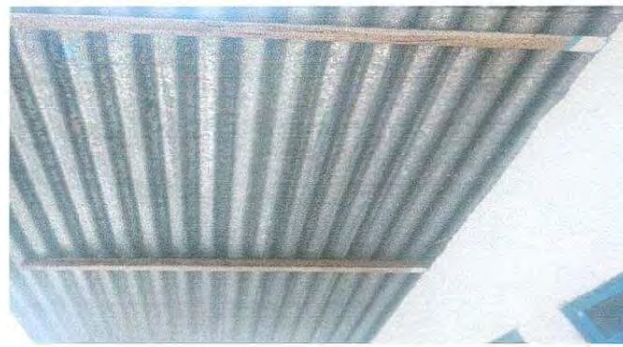
Foto 2: Se observa las costaneras de madera en mal estado, deben cambiarse por metal.
