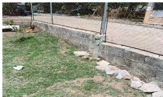
Foto 10: Se observa que las paredes necesitan pintura
