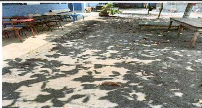
Foto 13: Se observa la necesidad de torta de concreto con un espesor mínimo de 10 cm.
