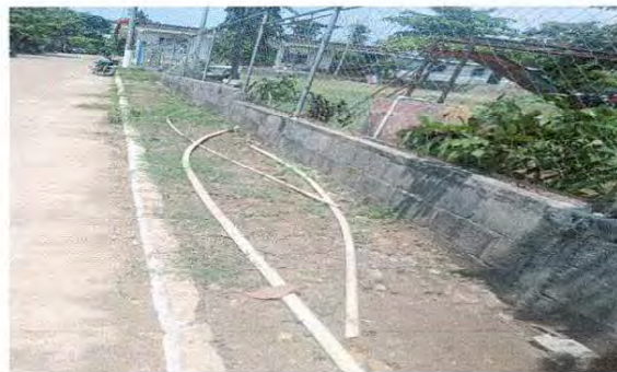
Foto 8: Se observa que el muro perimetral se esta dañando y humedeciendo, por lo que se necesita repellarlo.
