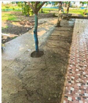
Foto 7: Se observa que en el área de patio frente al módulo 1 no se cuenta con piso cerámico por lo que este deberá ser suministrado.
