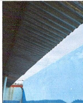
Foto 4: Se observa que en el frente del módulo 2 no se cuenta con canal de metal.
