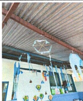
Foto 3: Se observa que la lámina del módulo 2 se encuentra deteriorada y con agujeros por lo que deberá ser sustituida.
