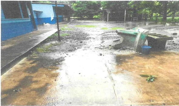
Foto 3: Se observa la necesidad de cambiar las pilas de dos lavaderos
