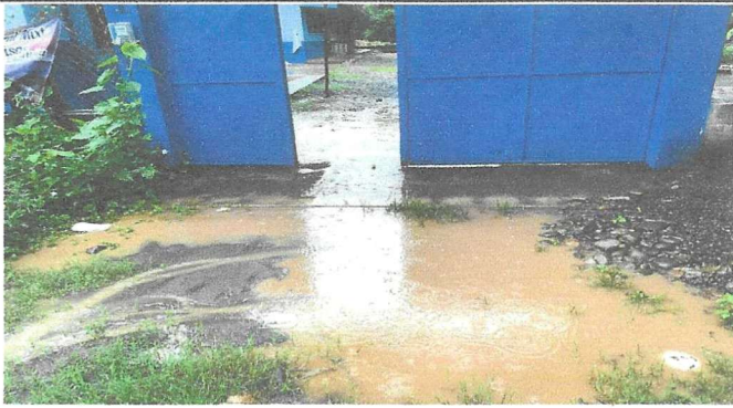
Foto 1: Se observa la necesidad de mejorar la plancha de concreto
