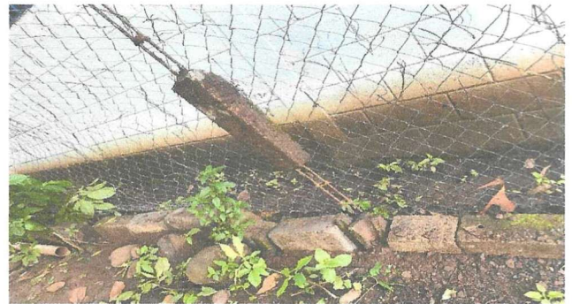
foto 4: se observa la necesidad de colocar muro perimetral
