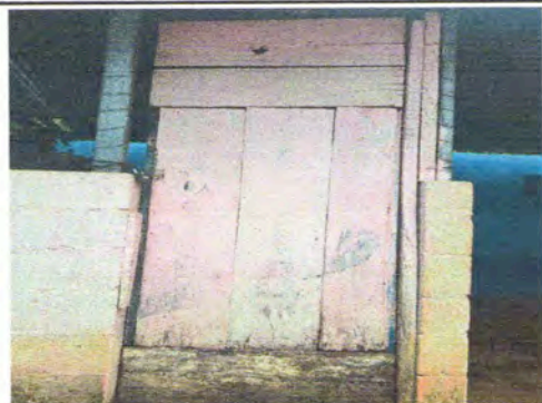
Foto 9: Puerta de madera en mal estado se instalará una de metal.
