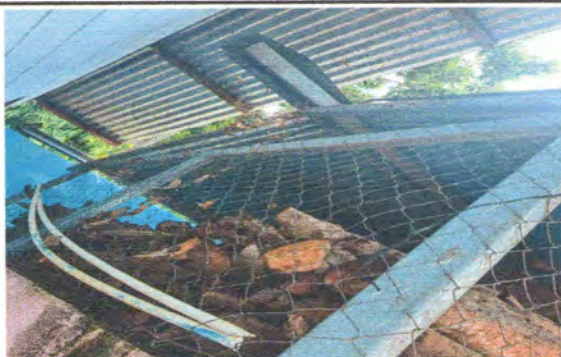
Foto 11: Malla en mal estado, se sustituirá por balcones de metal.
