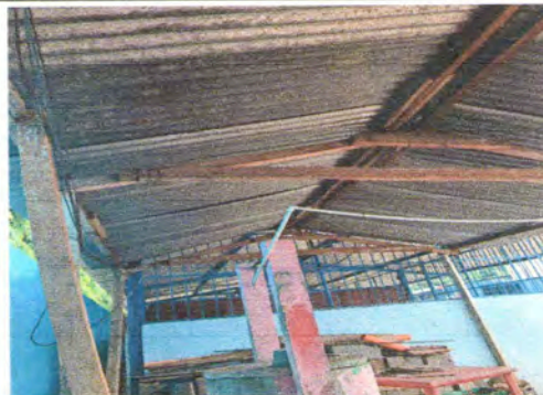
Foto 8: Los soportes de madera se encuentran en muy mal estado se sustituirán por metal.
