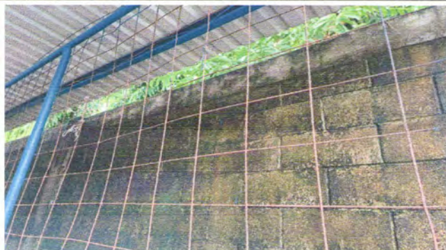
Foto 1: Se observa el mal estado de la electromalla, se sustituirá por balcones de metal.
