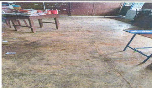
Foto 3: Se observa que el piso liso se encuentra en mal estado se sustituirá por piso cerámico.
