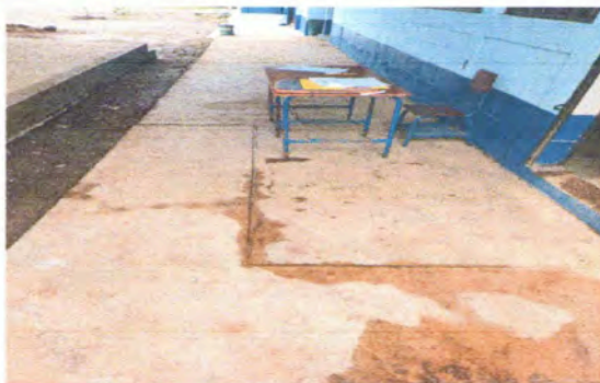
Foto 4: Se observa que el piso liso se encuentra en mal estado se sustituirá por piso cerámico.
