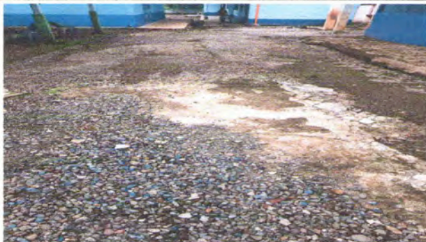
Foto 13: Torta de cemento totalmente desgastada se sustituirá.
