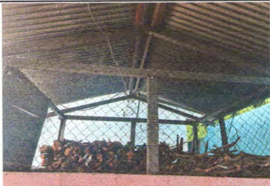
Foto 7: Se observa que el soporte de metal necesita mantenimiento.
