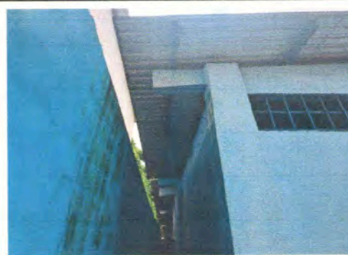
Foto 12: Se observa que estas estructuras no cuentan con canal para la bajada de agua pluvial
