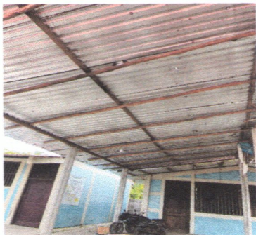
Foto 1: Se observa la necesidad de cambiar lamina
