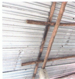
Foto 2: Se observa que la madera ya esta algo deteriorada y se cambiara la madera por madera nueva ya que en el area en donde estamos no podemos utilizar costaneras de metal por el salitre.
