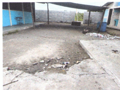
Foto 6: Se necesita terminar la torta de cemento que falta por seguridad de los estudiantes.
