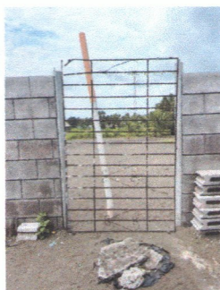
Foto 5: Se necesita cambiar el portón.
