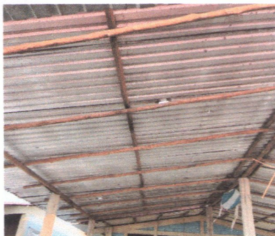
Foto 3: Se observa que la estructura algo dañada y se le dara mantenimiento, puliendo y aplicandole barniz.
