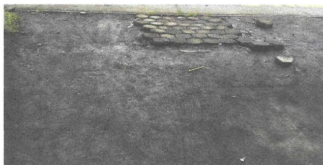
Foto 10: Se observa la necesidad de mejorar el ingreso principal con plancha de concreto
