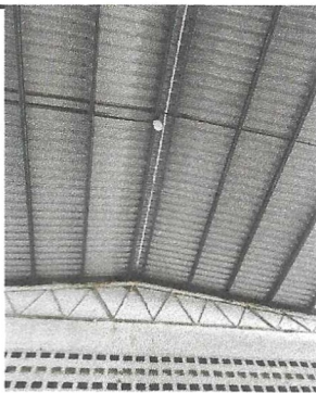
Foto 9: Se observa la necesidad de mejorar el sistema de luminarias
