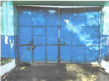
Foto 7: Se observa la necesidad del cambio de portón de ingreso
