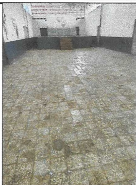
Foto 1: Se observa la necesidad de mejorar el piso existente del salon
