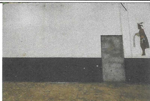
Foto 2: Se observa la necesidad pintar el interior del salon
