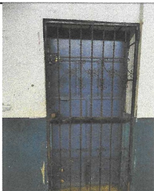
Foto 3: Se observa la necesidad del mantenimiento de las puerta
